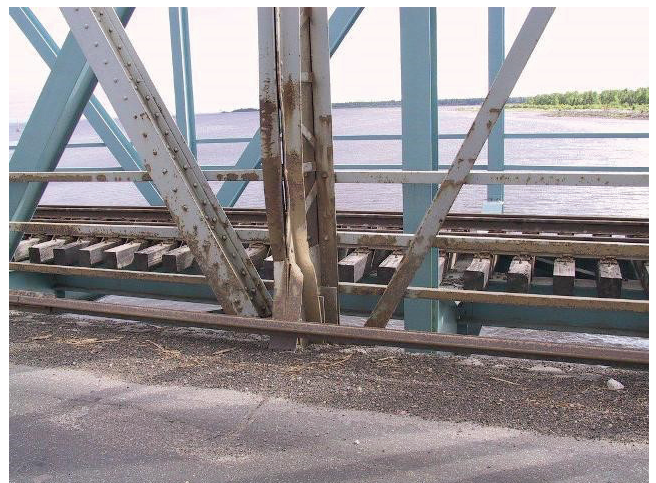
Kuva 67. Törmäysvaurio ristikkosillan vertikaalisauvassa. Ajoradan ja ristikkorakenteen sauvojen välissä ei ole kaidetta.
