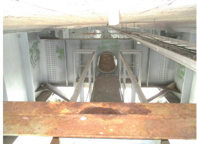
Kuva 77. Tippuputki on sijoitettu virheellisesti poikkiristikon kohdalle. Tippuputkesta valuva vesi on vaurioittanut pinnoitteen ja korrosio on edennyt poikkiristikon koko yläpaarten osalle.
