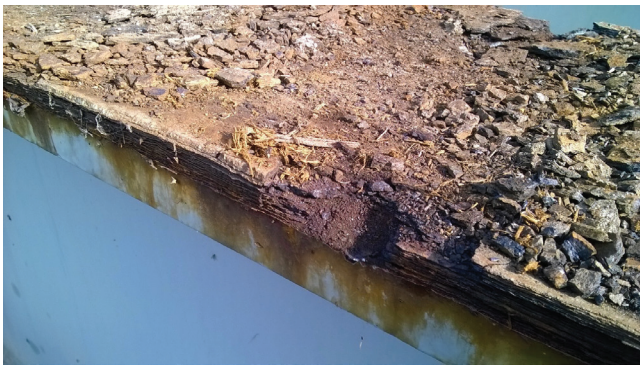
Kuva 60. Palkin ylälaipan korroosiovaurioita. Kyllästetyn puukannen tukeutuminen suoraan ylälaipan päälle on lisännyt korroosiota.
