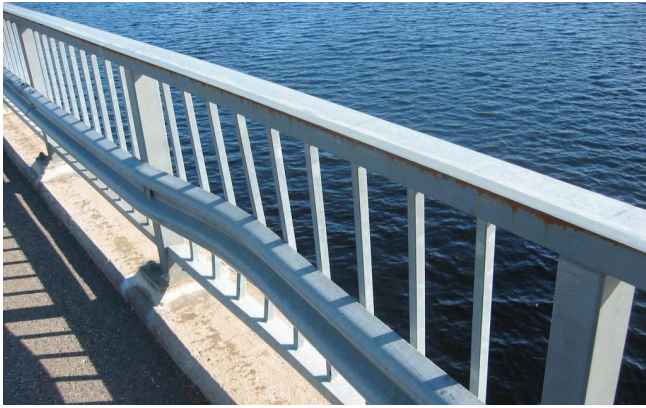
Kuva 68. Törmäysvaurio sillan kaiteessa.
