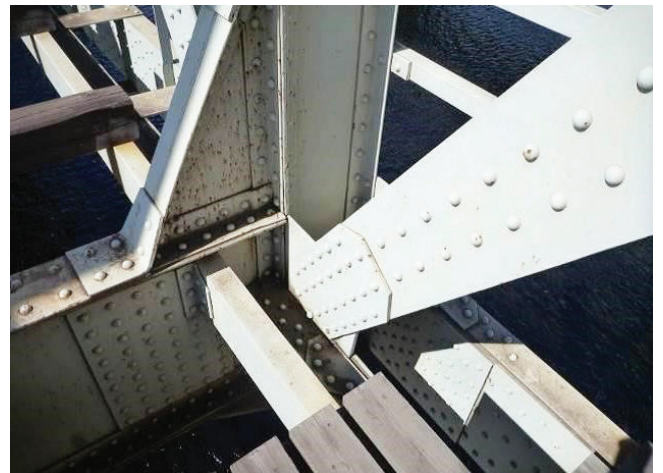
Kuva 51. Niitatus ristikkosillan vertikaali- ja diagonaalisauvojen liitos alapaarteeseen. Vertikaalisauvan ja poikkipalkin välinen liitos on jäykistetty kolmiomaisella teräs-rakenteella.
