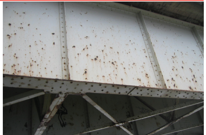
Kuva 32. Niittaamalla koottu pääpalkki. Ylä- ja alalaipat on yhdistetty uumaan niitattujen L-terästen avulla. Pystyjäykisteet on tehty niittaamalla uuman molemmille puolille L-teräkset.
