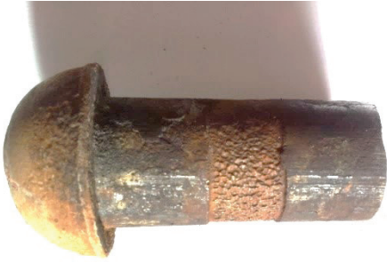
Kuva 79. Niitti, jossa on reikien epäkeskisyydestä johtuvia teräviä kulmia, jotka voi aiheuttaa vikakaiun ultraäänitarkastuksessa vaikka niitti olisi vielä muuten toimiva.
