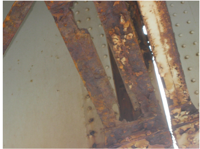
Kuva 62. Poikkiristikon alapaarteen syöpymisvaurio vuotavan liikuntasaumalaitteen kohdalla.
