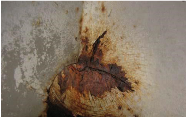
Kuva 70. Väsymyssärö palkin uumassa pystyjäykisteen alapään kohdalla.
