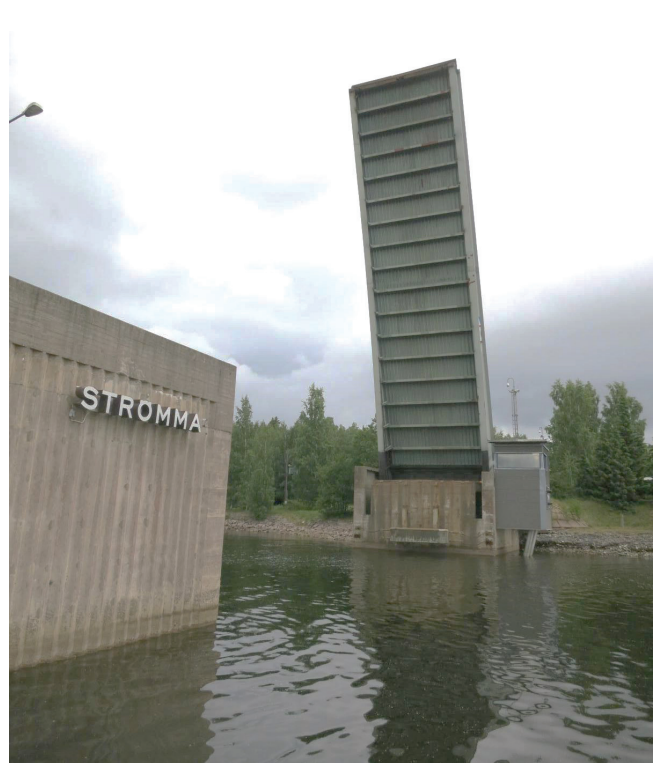
Kuva 31. Avattava teräsrakenteinen läppäsilta.
