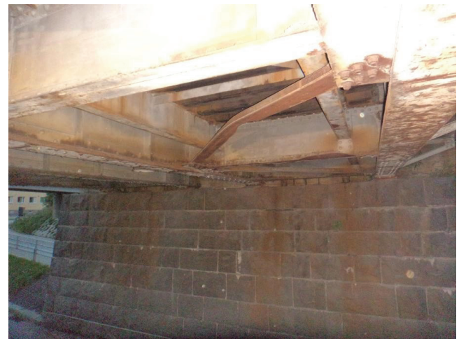
Kuva 66. Törmäysvaurio alikulkusillan päällysrakenteen alaosan vaakajäkistysristikon diagonaalisauvassa.
