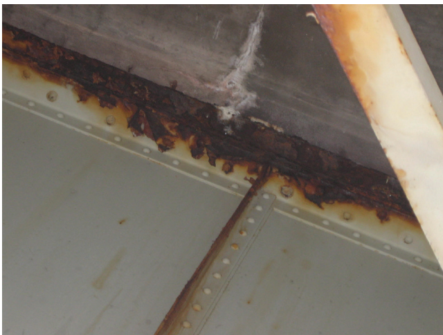
Kuva 61. Palkin ylälaipan syöpymisvaurio kansilaatan vuotokohdassa.
