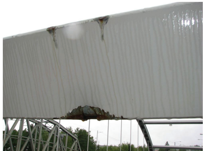
Kuva 65. Törmäysvaurio Langer-palkkisillan alimmaisessa kaaren poikkipalkissa.
