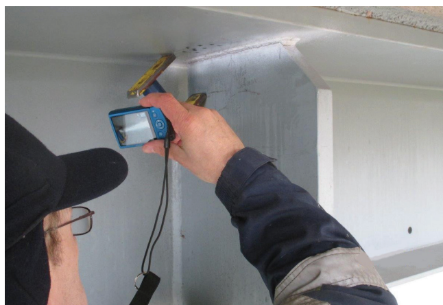
Kuva 1. Teräspalkin ylälaipan ja pystyjäykisteen välisen hitsin magneettijauhetarkastus.
