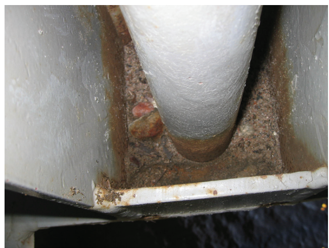
Kuva 63. Likaa ja vettä keräävä vetotangon alapään liitos. Korjaustöiden yhteydessä tämän tyyppiset detaljit tulisi suojata peitelevyillä pintakäsittelyn uusimisen jälkeen.
