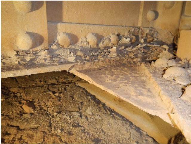
Kuva 59. Pääpalkin ja poikkipalkin välisen liitoksen vaakasuoran liitoslevyn syöpymisvaurio
