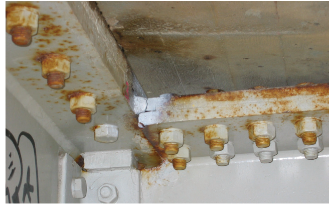
Kuva 72. Langer-palkkisillan poikkipalkin ylälaipan epäkeskinen liitos pääpalkkiin.
