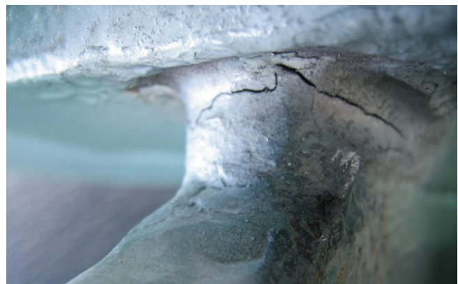
Kuva 69. Särö köysipoikkipalkin alalaipan ja pääpalkin uuman välisessä hitsiliitoksessa.
