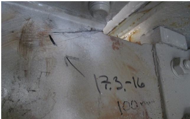
Kuva 71. Langer-palkkisillan pääpalkin ja pääty-poikkipalkin välinen liitos. Pääpalkin ylälaippaan hitsatun kiinnityslevyn saumakohdassa oleva särö kuvattuna magneettijauhetarkastuksen jälkeen.
