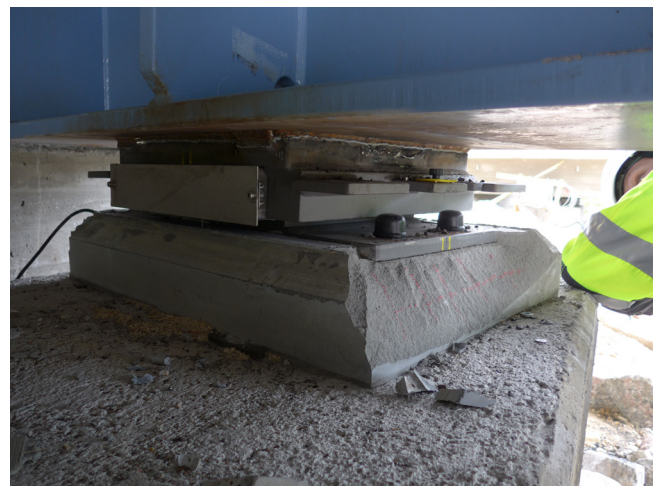
Kuva 20. Kiinteän kalottilaakerin laakerialusta on lohjennut, kun jäänytynyt maa on estänyt pilarin liikkeitä (L-2277 Palojoensuun silta).
