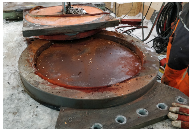
Kuva 14. Laakerin ulko- ja sisäpuolinen tiiviste ovat vaurioituneet, laakerissa on ruostetta (U-3072 Tähtiniemen silta).
