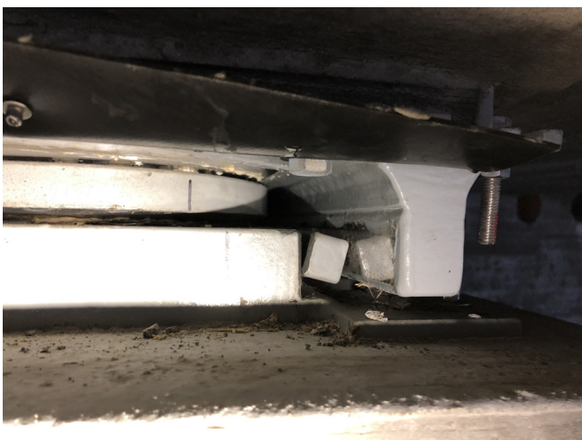
Kuva 22. Laakerin ohjureiden rikkoutuminen valmistusvirheen takia (U-5901 Soramäen risteysilta).
