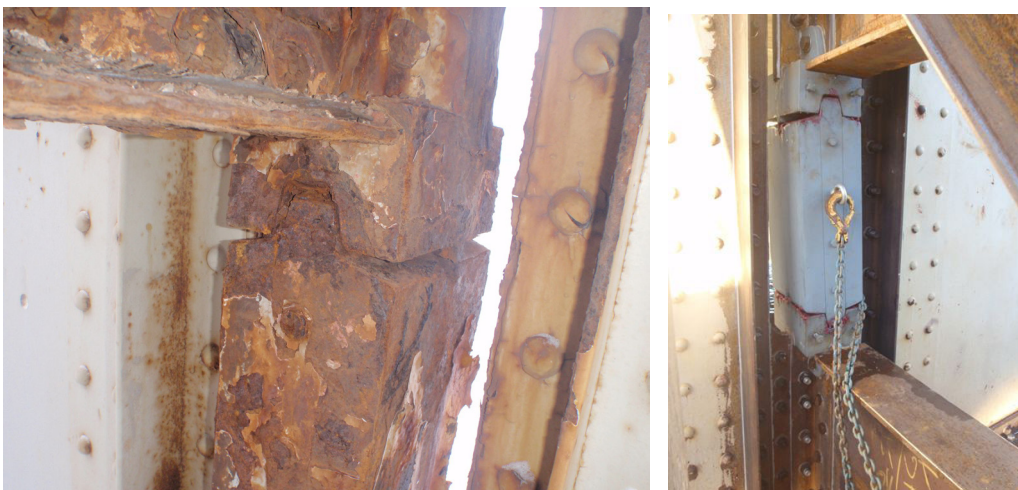
Kuva 10. Nivelpalkkisillan ruostunut ja vanhojen suunnitelmien mukaan tehty uusi liikkuva nivel (U-286 Espoonlahden silta).
