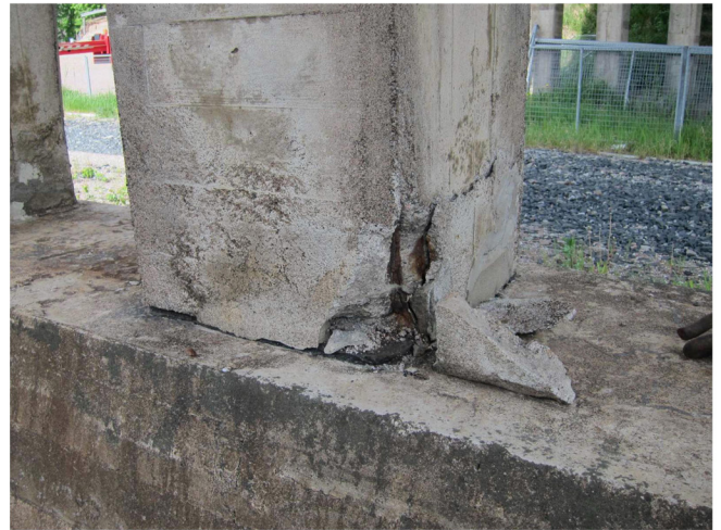
Kuva 15. Betonin lohkeilua betoninivelen kohdalla (Karjaan ylikulkusilta)
