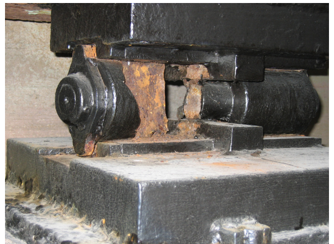
Kuva 16. Katkennut rullalaakeri (KaS-766 Keltin silta).
