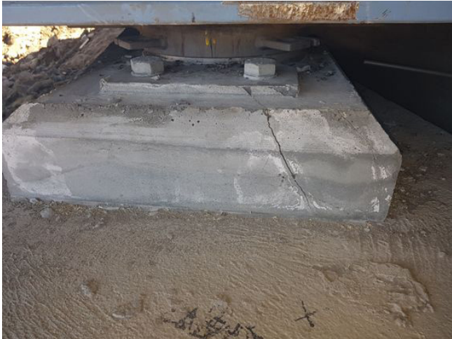
Kuva 18. Alusvalun halkeilua (L-2277 Palojoensuun silta).
