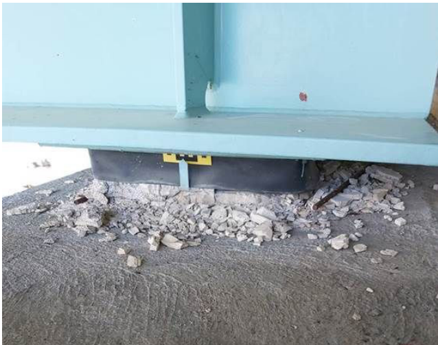
Kuva 25. Laakerin alusvalu on rikkoutunut työvirheen seurauksena ja raudoitusteräukset ovat irti. Rauditus ei ole ohjeiden mukainen (L-2056 Liakanjoen silta).
