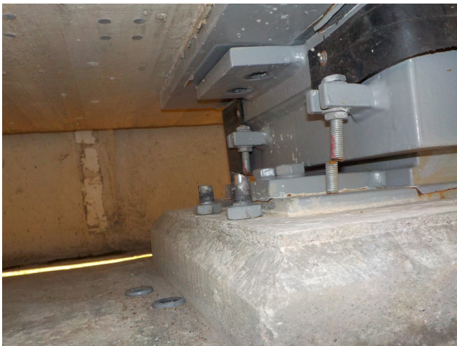
Kuva 19. Yläpuolen kiinnitysruuvit ovat katkonneet ja pudonneet tuen siirtymän takia (O-4836 Kalajoen ratasilta).
