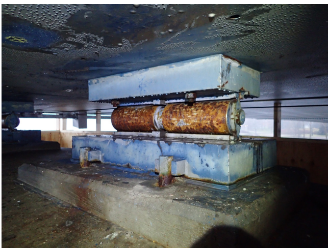
Kuva 13. Puutteellisen huoltokäsittelyn vuoksi ruostunut laakeri (KaS-753 Mansikkakosken silta).
