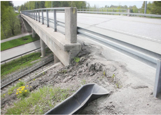
Kuva 9. Eroosioaurion aiheuttama painuma sekä puutteellinen vedenohjaus.
