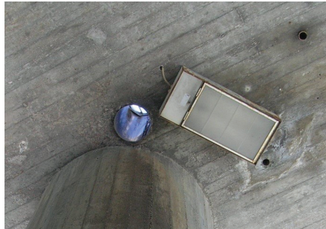
Kuva 14. Liian lyhyt tippuputki ja jatkamatta jäänyt syöksytorvi.
