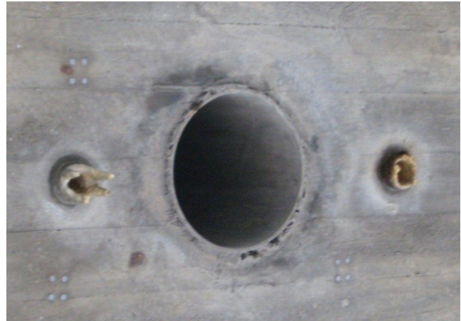
Kuva 5. Kuivatuslaitteet ovat liian lyhyet ja niissä on ulkopuolista vuotoa.
