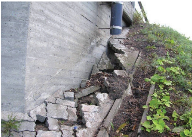
Kuva 10. Puutteellisen vedenohjauksen aiheuttama sortuma.
