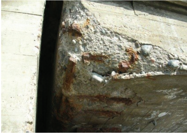
Kuva 13. Saumoista vuotava kloridipitoinen vesi on aiheuttanut pakkasrapautumista ja korroosiota kannen päähän.
