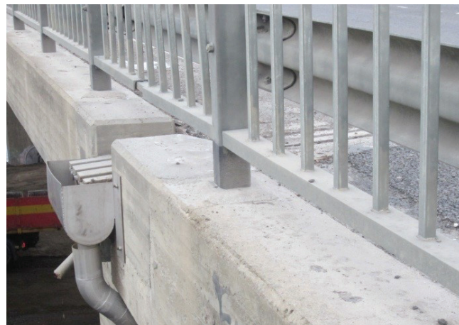
Kuva 24. Vedenkerääjä ja syöksytorvi liikuntasaumalaitteen päässä.
