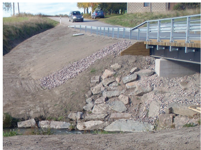
Kuva 37. Kivisuotokouru sivuluiskassa sillan päässä.
