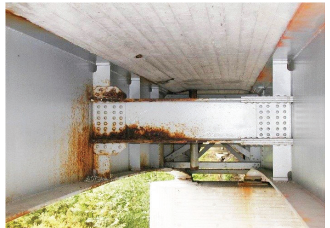
Kuva 12. Tippuputkesta valunut vesi on vaurioittanut teräspalkin pintakäsittelyn.
