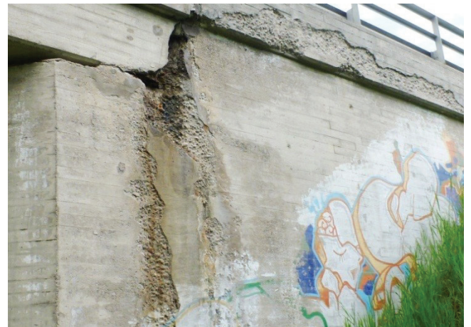
Kuva 11. Puutteellinen saumaus on aiheuttanut rapautumavauriota betonirakenteisiin.
