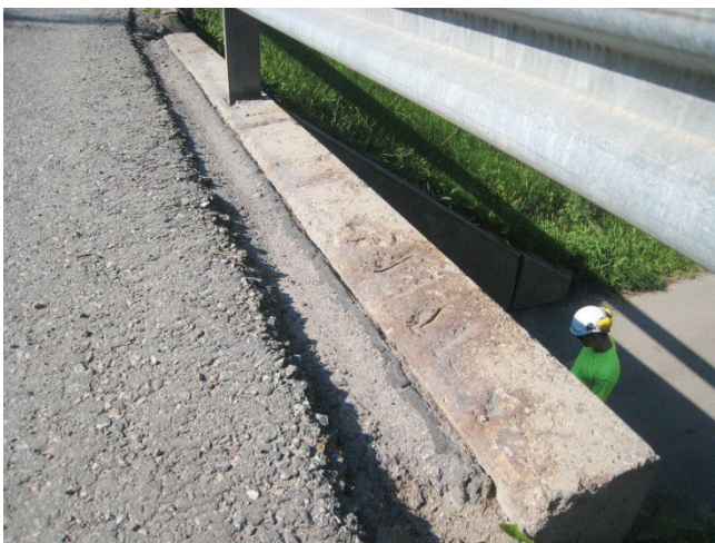
Kuva 36. Hulevesien ohjaus päällysteestä tehdyn reunakourun avulla.
