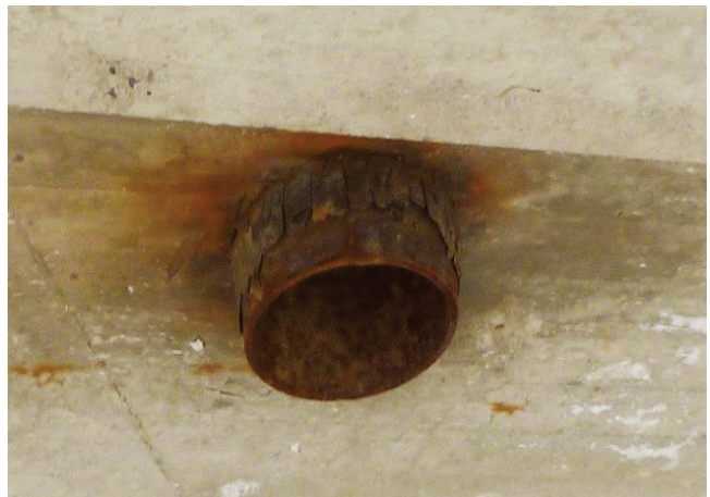
Kuva 6. Syöksytorvi on ruostunut.
