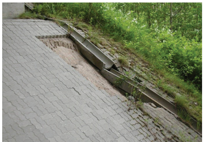
Kuva 7. Hulevesikouru ja verhous ovat sortuneet eroosioaurion seurauksena.
