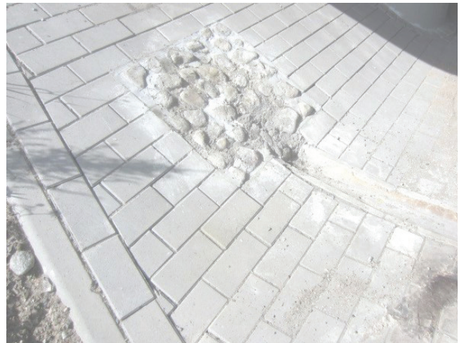
Kuva 40. Kivisilmä syöksytorven alla.
