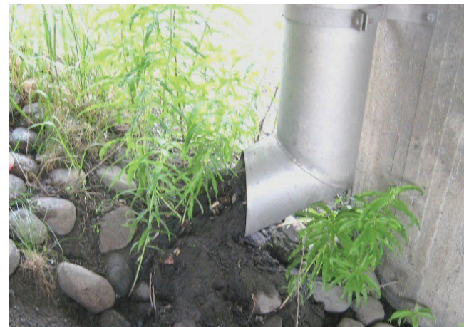
Kuva 15. Syöksytorven purkualueen puhdistus on laiminlyöty.
