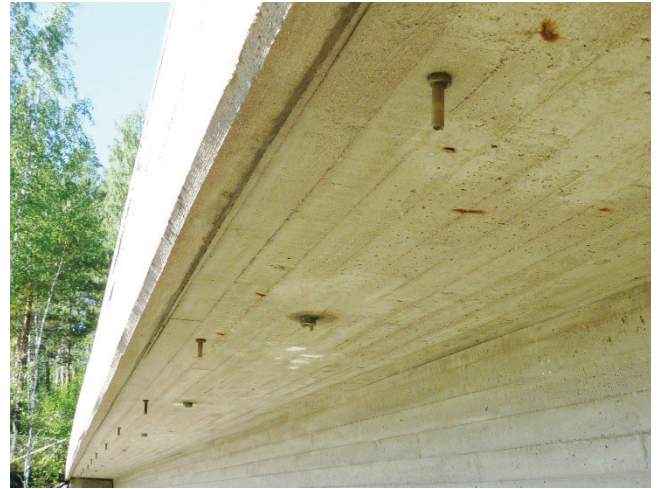
Kuva 44. Kaidepylvään juuriin porattuihin reikiin liimatut tippuputket.
