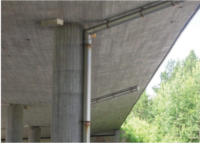
Kuva 16. Syöksytorven jatko-osa kiinnitetty ruostuvilla kiinnikkeillä.
