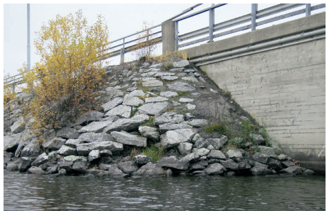
Kuva 10. Verhouksen juuri on vaurioitunut.
