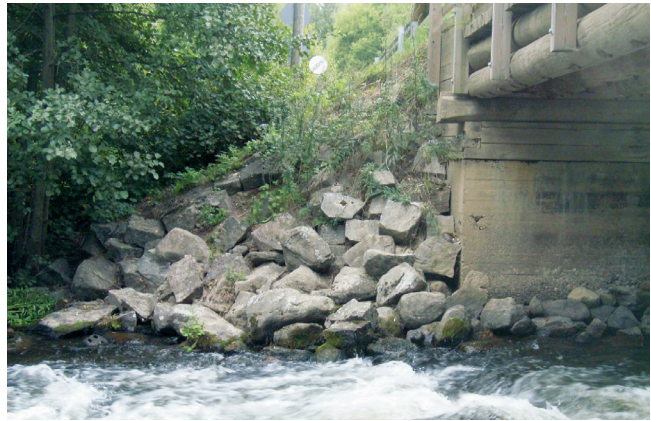
Kuva 9. Perustusten peittämissä vuoksi vaurioitunut keila.
