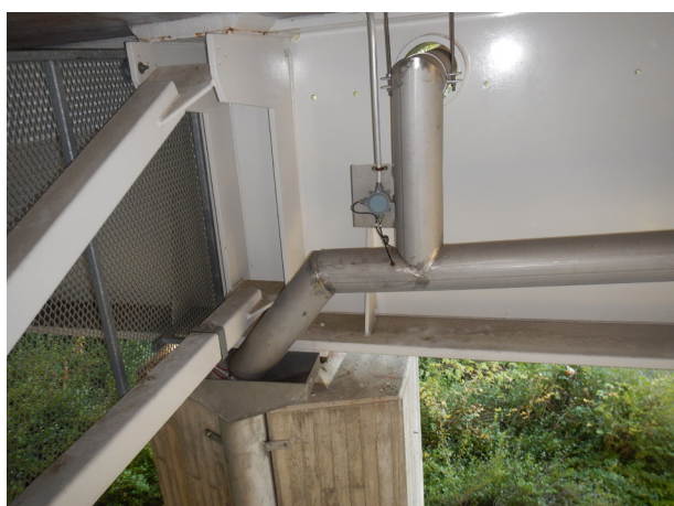
Kuva 9. Jatkoputki varustettu sulatuskaapelilla.
