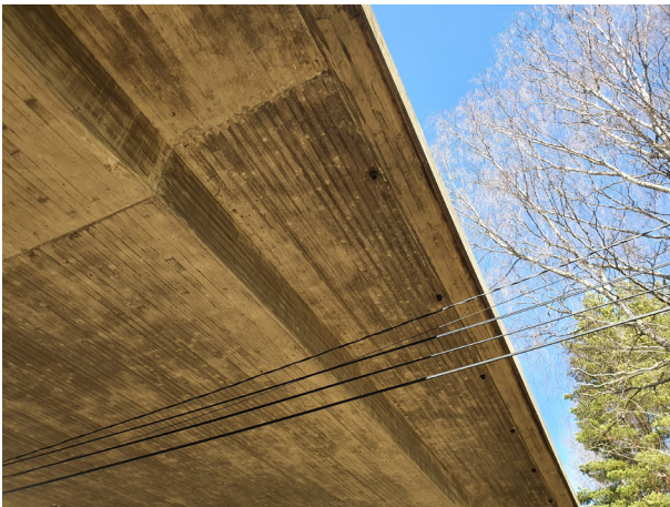
Kuva 3. Tippuputket sijoitettu virheellisesti ajojohteen päälle.
