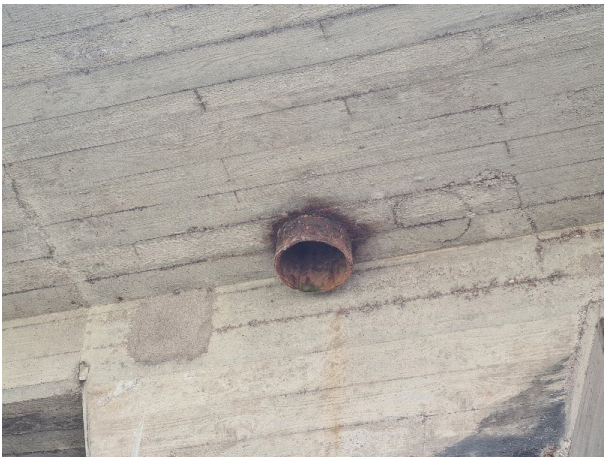
Kuva 3. Puhki ruostunut hulevesiputki.
