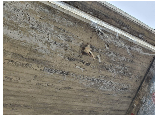
Kuva 4. Kuivatusjärjestelmä on ollut pitkään riittämätön.
