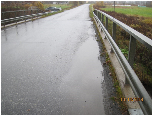
Kuva 1. Kannen hulevesiputki puuttuu.
