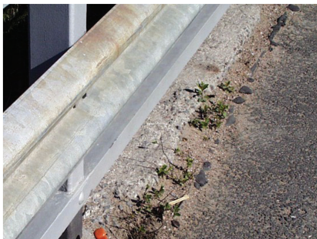
Kuva 2. Saumausmassa ylittänyt käyttöikänsä ja irtoillut.
