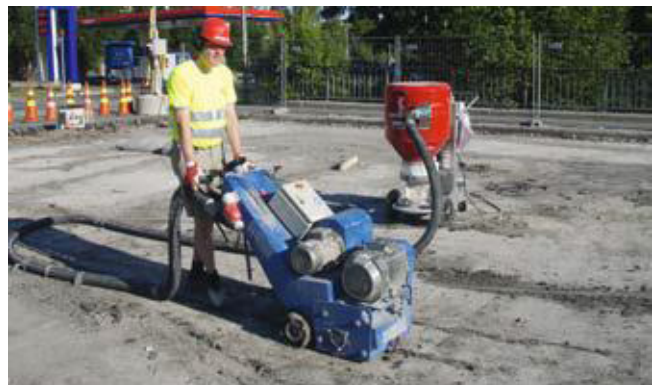
Kuva 5. Pinta viimeistellään ja reunat sekä muut vaikeapääsyiset kohdat jyrsitään käsin ohjattavalla jyrsimellä.
