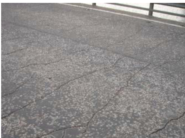
Kuva 2. Kauttaaltaan halkeillut päällyste en .
