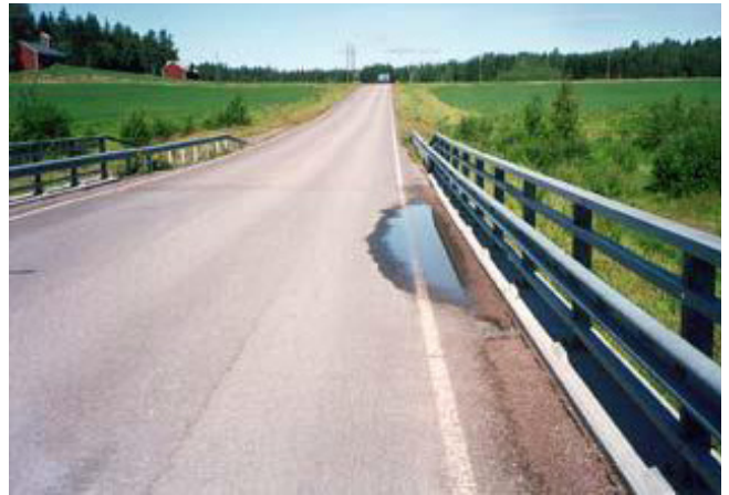
Kuva 13. Vesi ei saa lammikoidua päällysteen pinnalle.
