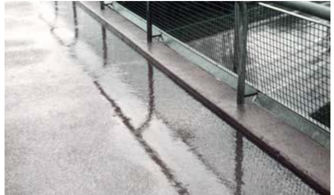
Kuva 11. Viiste päällysteen reunassa.
