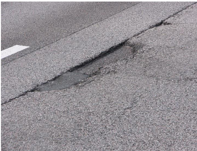
Kuva 1. Päällysteen purkauma ajokaistojen välisen saumapaikkauksen vieressä.
