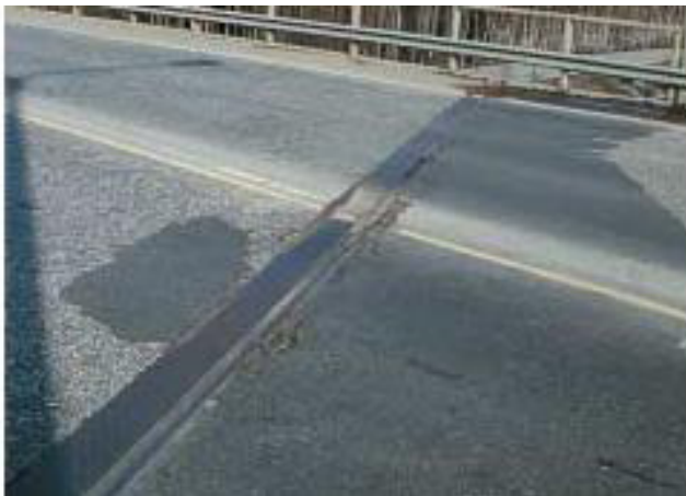
Kuva 2. Kynnys sillan ja penkereen rajakohdassa aiheuttaa iskuja siltarakenteille.
