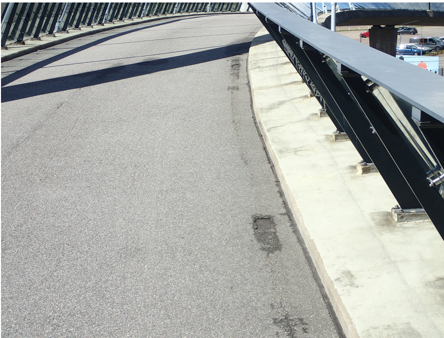
Kuva 1. Esiin tullut salaoja kuivatuslinjalla liian ohuista päällysteistä johtuen
