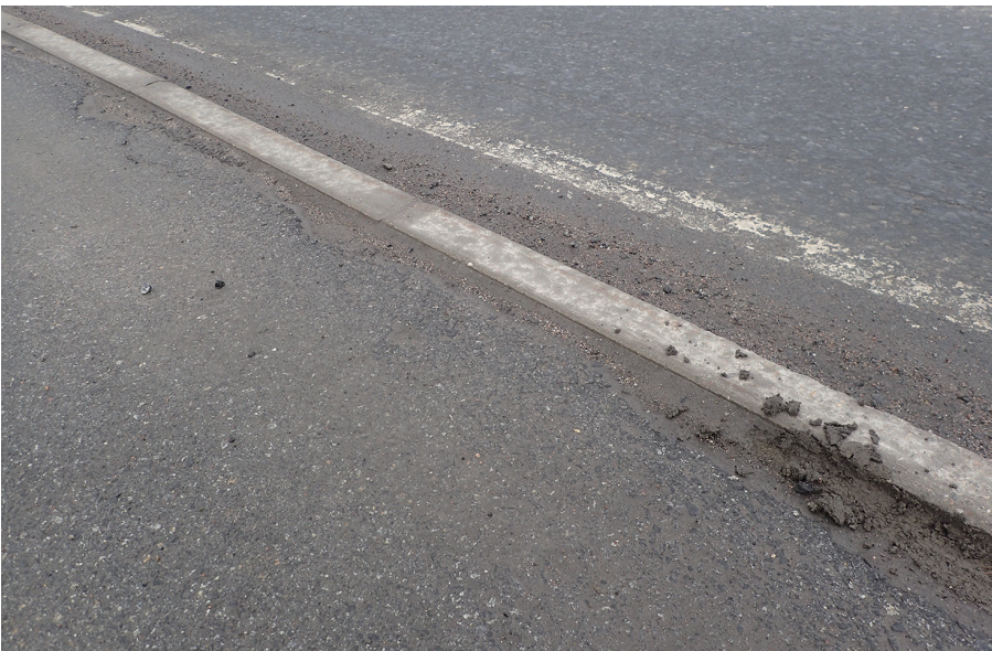
Kuva 2. Päällysteen purkautuma reunakiven takana
