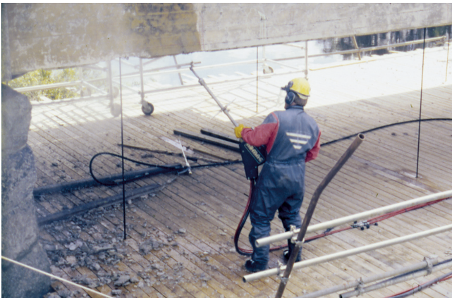
Kuva 27. Työturvallisuus on otettava huomioon telineissä ja kulkuteissä
