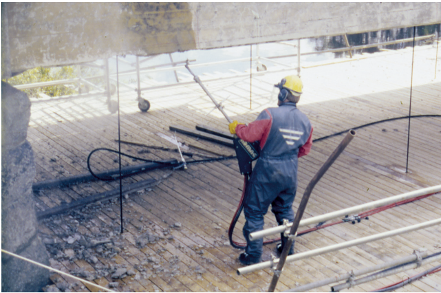
Kuva 15. Työturvallisuus on otettava huomioon telineissä ja kulkuteissä
