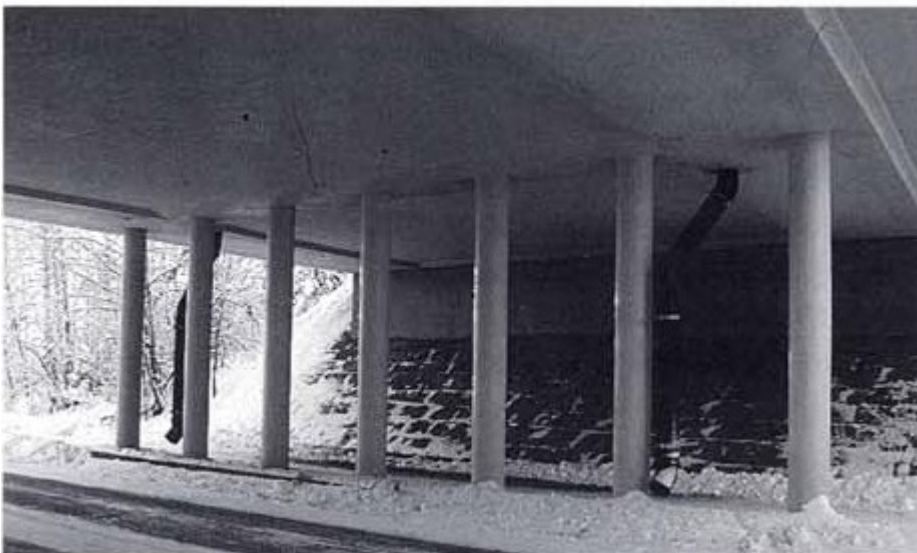
Kuva 27. Polyeteeniputkista tehdyt syöksytorvet
