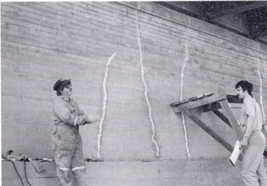
Kuva 16. Injektoituja maatuen kutistumishalkeamia
