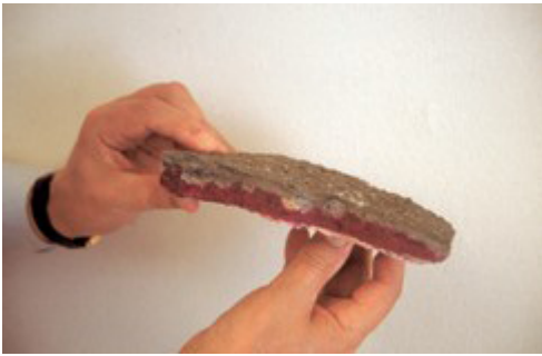
Kuva 10. Ruiskubetoni on karbonatisoitunut 10 vuodessa lähes kokonaan
