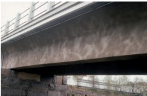
Kuva 18. Värisävyltään häiritsevästi vaihteleva ruiskubetonin pinta
