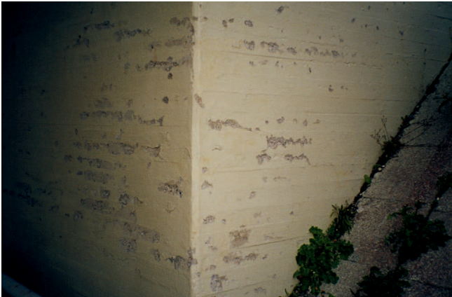
Kuva 5. Liian tiiviin pinnoitteen aiheuttama pakkasvaurio
