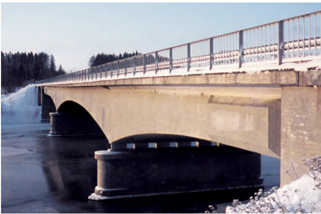
Kuva 2. Slammattuja betonipintoja (Nokianvirran silta, Nokia)
