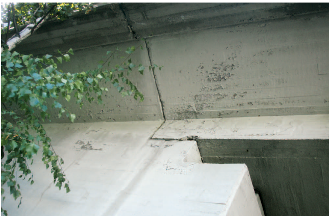
Kuva 6. Pinnoitekerrokset ovat irronneet toisistaan vesivuodon ja työvirheen vuoksi
