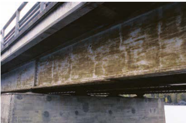
Kuva 32. Puutteellinen esikäsittely on yleisin syy pinnoitevaurioihin
