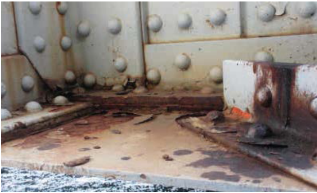
Kuva 8. Ristikkorakenteen niittiliitos, jossa korroosioauriota ovat aiheuttaneet niin puutteellinen puhdistus kuin korroosioherkät detaljit (raot, vaakapinnat)
