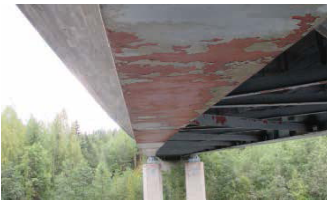
Kuva 9. Pintamaalikerros on hilseillyt irti laajoilta alueilta
