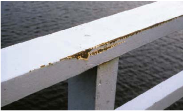
Kuva 10. Ruostunut naarmu kaiteen yläjohteessa
