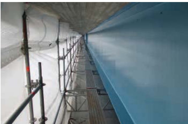
Kuva 29. Sääsuoja ja telineet
