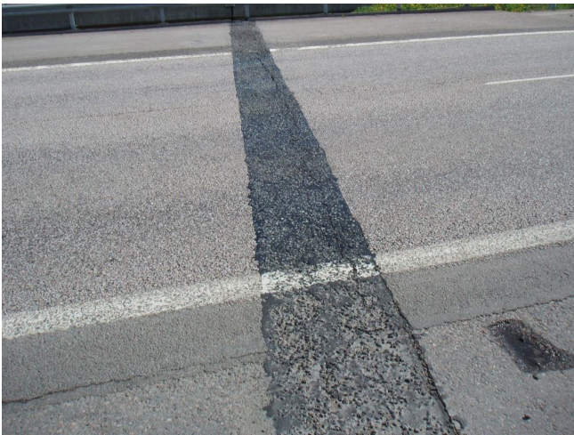
Kuva 14. Polymeeribituminen massaliikuntasauva. Kuvassa näkyvät vauriot ja puutteet: massaliikuntasaumassa on sauman suuntainen halkeama (sauman liikevara on liian lyhyt), saumamassan ja asfaltin välinen tartunta on pettänyt (rako massaliikuntasauvan ja asfaltin välissä)
