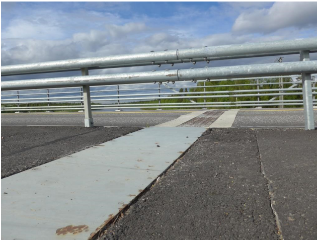
Kuva 4. Peitelevyllä varustettu vesitiivis liikuntasaumalaite (kuvassa näkyvät vauriot tai puutteet: peitelevyn pinnoite on vaurioitunut ja levy on ruostunut)
