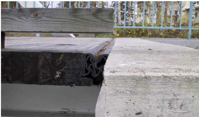
Kuva 6. Nauhaliikuntasauma (kuvassa näkyvät vauriot tai puutteet: kumiprofiilin urassa on roskia ja hiekkaa)
