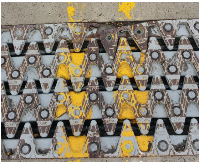
Kuva 12. Rengasmelua vaimentavat hiljentimet asennettuna monikumisen liikuntasaumalaitteen teräsprofiilien päälle (kuvassa näkyvät vauriot tai puutteet: hiljennyslevyihin on törmätty auralla siten, että levy on paikallisesti taipunut ja kiinnikkeet ovat leikkaantuneet poikki, tukikaistassa on pieniä lohkeamia törmäysvaurion kohdalla, hiljenninlevyjen pinnoite on kulunut ja levyt ovat pintaruosteessa)
