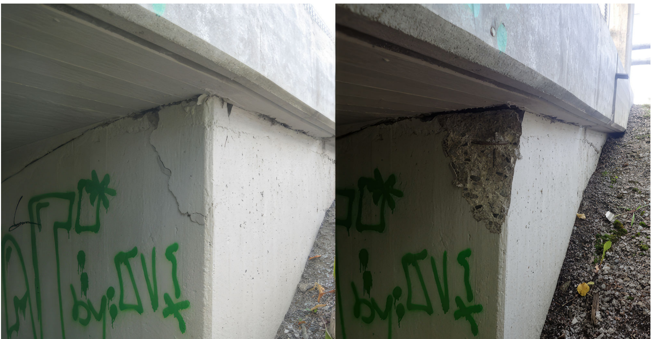
Kuva 7. Korjaamaton vaurio etenee (kuvat otettu kolmen vuoden välein samasta vauriosta), paikkaus muottien avulla
