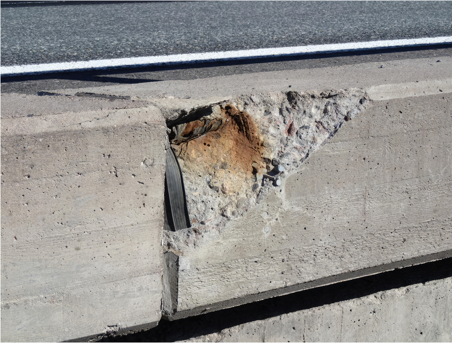
Kuva 3. Reunapalkin raudoituksen korrosio on aiheuttanut suuren lohkeaman, paikkaus muottien avulla
