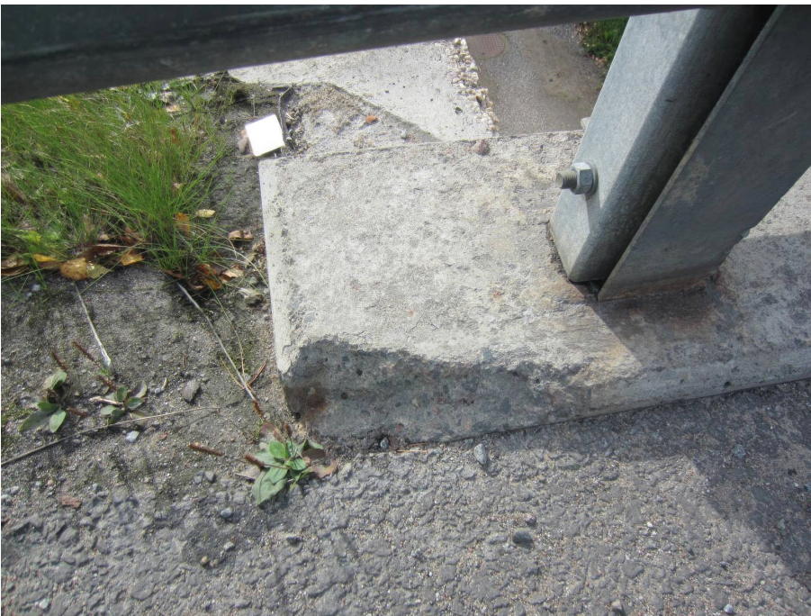
Kuva 4. Tyypillinen auraskaluston aiheuttama törmäysvaurio reunapalkin päässä, paikkaus muottien avulla
