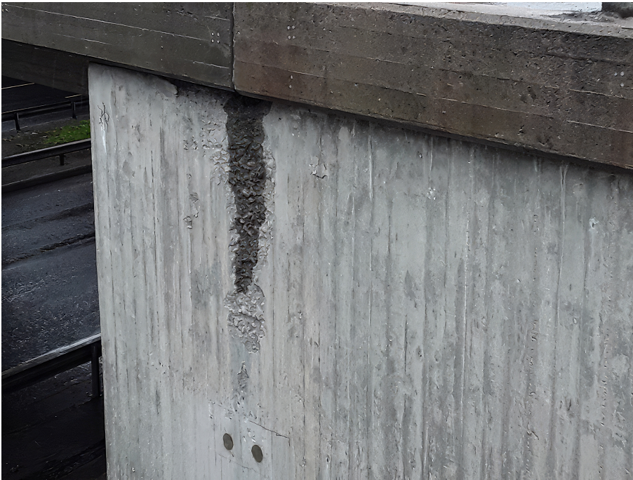
Kuva 8. Vesivuodon aiheuttama rapautumavaurio korjataan peruskorjauksen yhteydessä
