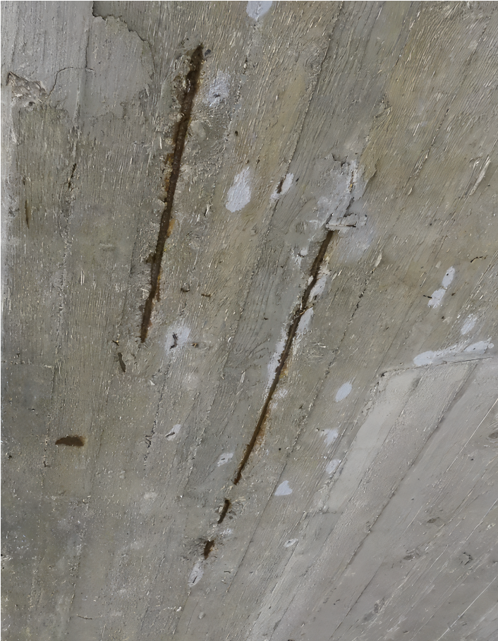
Kuva 5. Liian ohuesta betonipeitteestä johtuva raudoitusteräksen ruosteaurio, paikkaus peruskorjauksen yhteydessä
