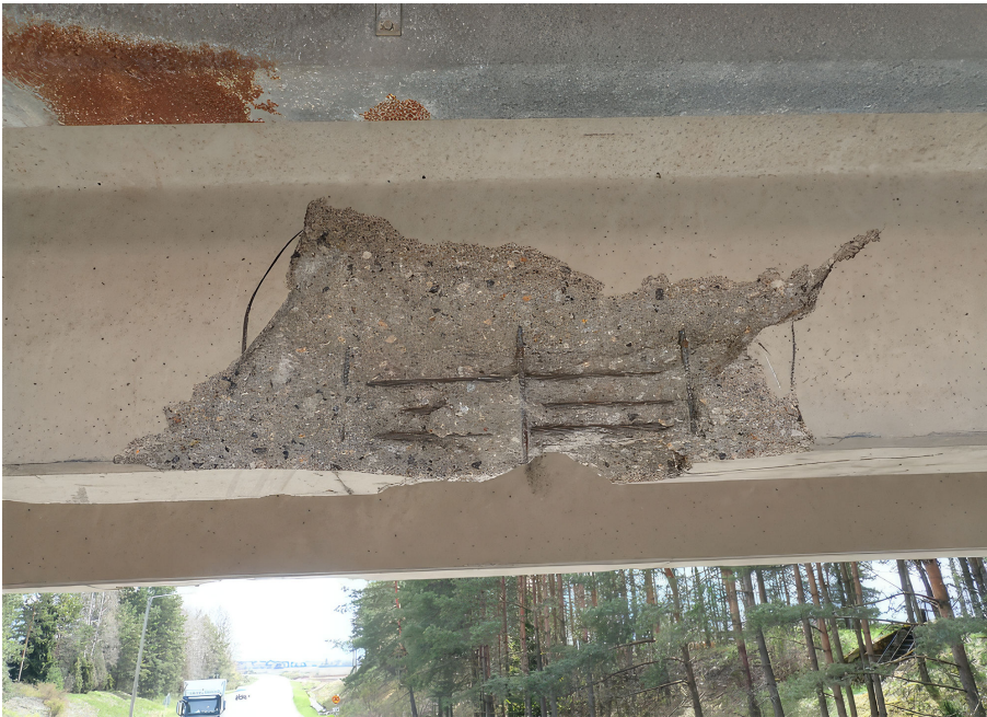
Kuva 6. Laaja törmäysvaurio, korjattava ensi tilassa muotin kanssa
