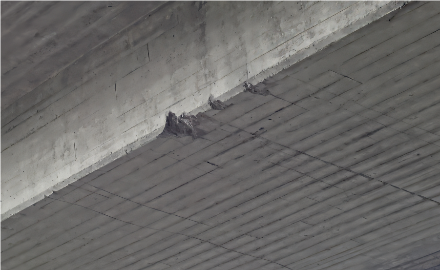
Kuva 1. Pieni törmäysvaurio, paikkaus ilman muotteja
