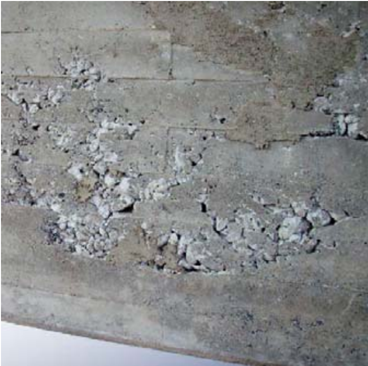
Kuva 1. Ejektoripaikkaukselle sopiva valuvika
