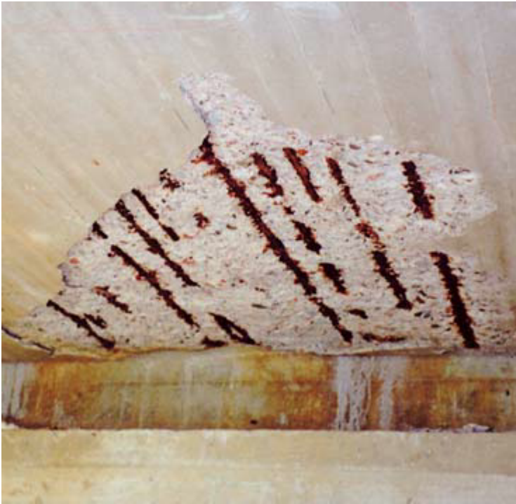
Kuva 2. Betonipeite lohkeaa pois raudituksen korroosion voimistuessa
