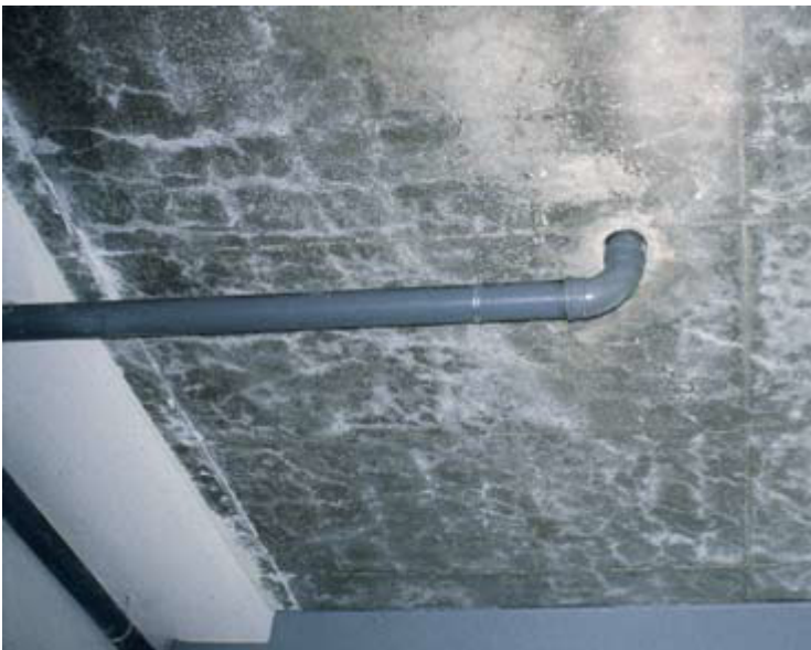
Kuva 1. Betonipeite halkeilee raudoituksen korroosion käynnistyttyä
