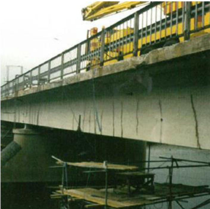
Kuva 1. Vinoja leikkaushalkeamia tukien lähellä ja pystysuoria taivutushalkeamia aukon keskellä
