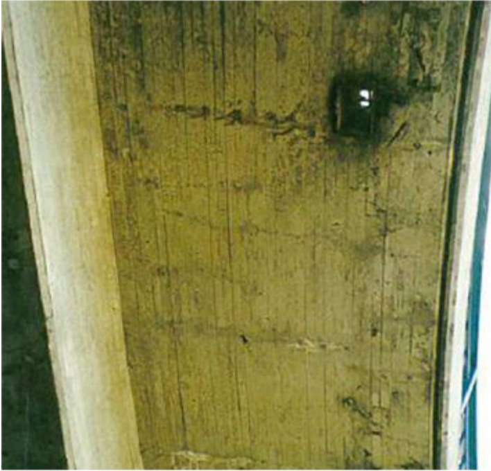
Kuva 2. Vesivuoto halkeaman kautta aiheuttaa seurausvaurioita
