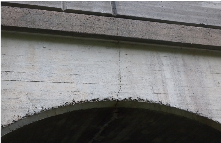
Kuva 1. Suuri halkeama (murtuma) rakenteessa
