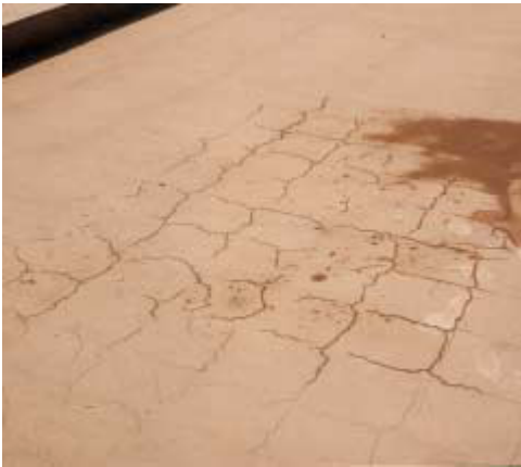
Kuva 2. Kansilaatan halkeamat paljastuvat yleensä suihkupuhdistuksen jälkeen ja erottuvat selvästi kuivuvasta pinnasta
