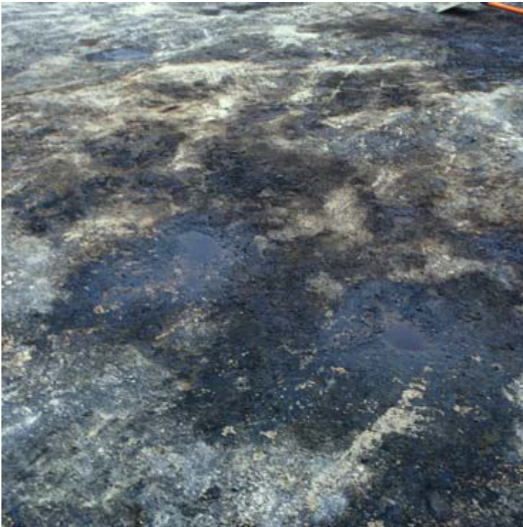
Kuva 1. Öljyä vedeneristyksen alustassa
