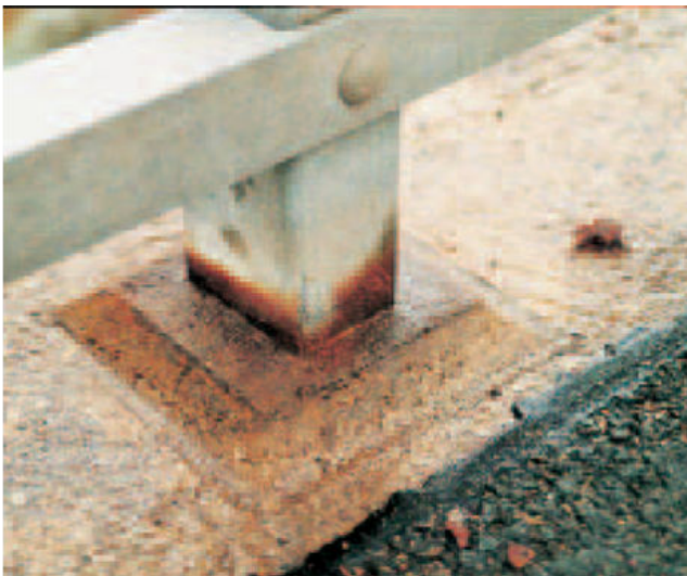
Kuva 1. Vaurioitunut kaidepylvään juuri
