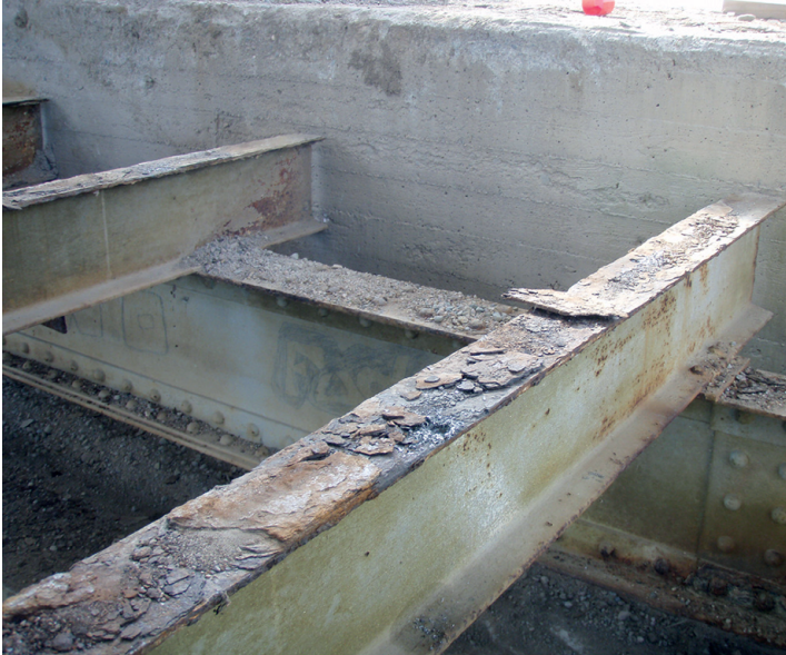
Kuva 2. Ruostuneet teräspalkkien ylälaipat
