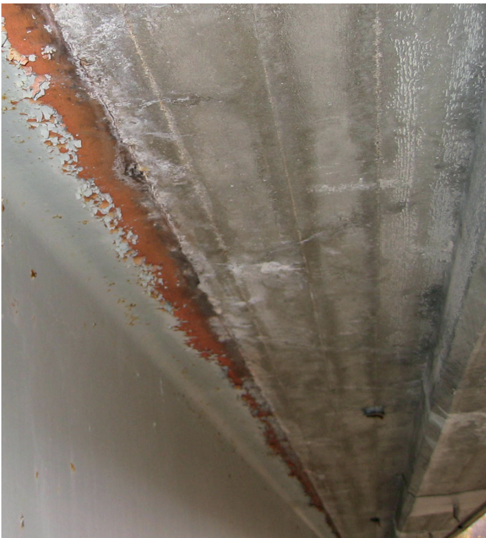
Kuva 1. Ylälaipan virheellisestä suojauksesta johtuva maalipinnoitteen vaurio
