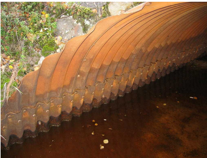
Kuva 1. Pahoin ruostunut teräsputkisilta (vaurioluokka 3)
