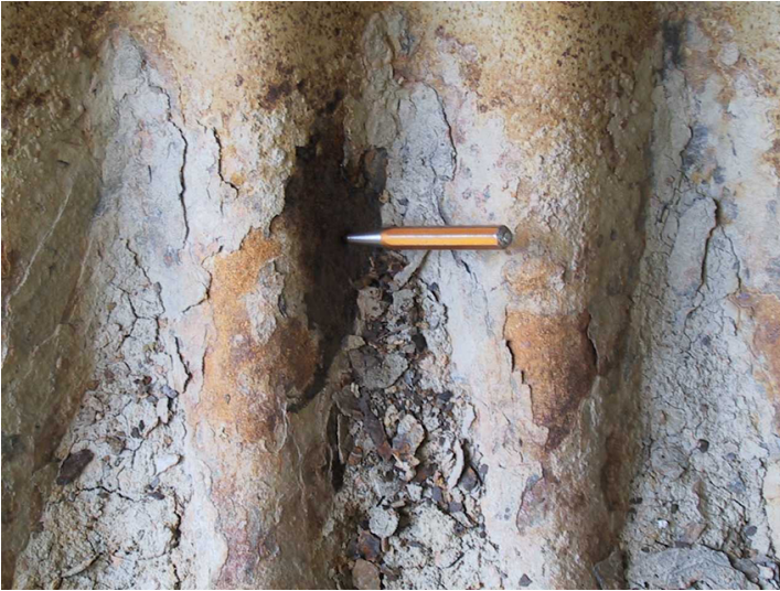
Kuva 2. Teräsputken vaurioluokitus tarkistetaan lopulliseksi piikitestin perusteella (vaurioluokka 4)
