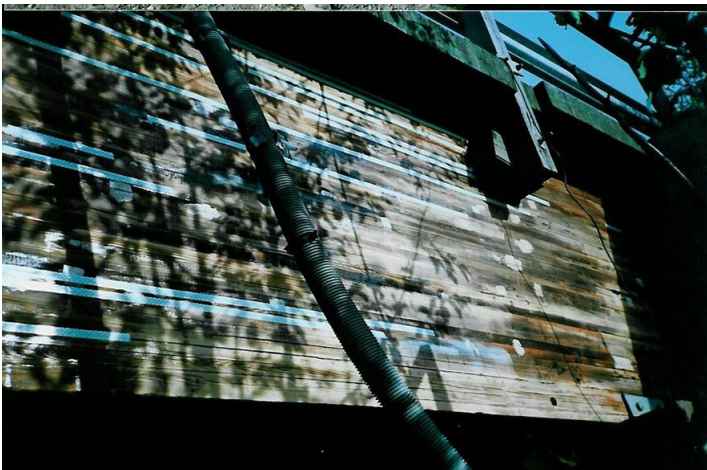
Kuva 3. Halkeamat on suljettu teipillä
