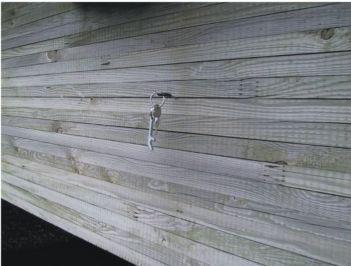
Kuva 1. Liimapuupalkin normaalia halkeilua, joka ei vaadi korjausta
