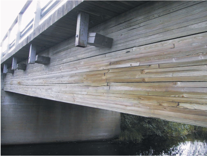
Kuva 2. Korjausta vaativia halkeamia ja liimasaumojia
