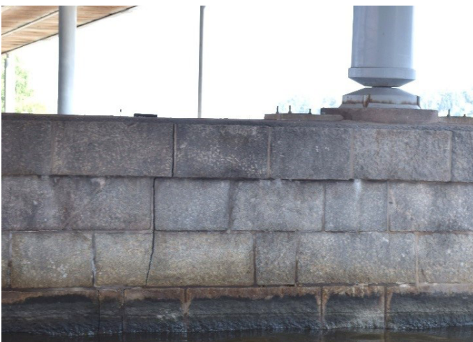
Kuva 1. Halkeamia kivisessä välituessa
