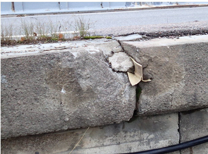
Kuva 2. Rapautuneet reunapalkit on korjattava ennen sauman tiivistämistä
