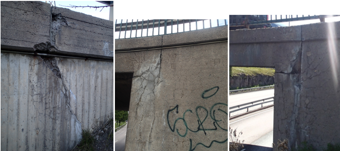
Kuva 1. Avonaisesta saumasta valuva suolainen vesi vaurioittaa alapuolisia rakenteita
