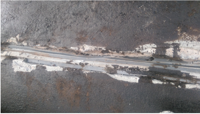
Kuva 5. Virheellisesti asennettu U-saumanauha rakenteen pinnassa, jossa laipat ovat nousseet puutteellisen sidonnan vuoksi
