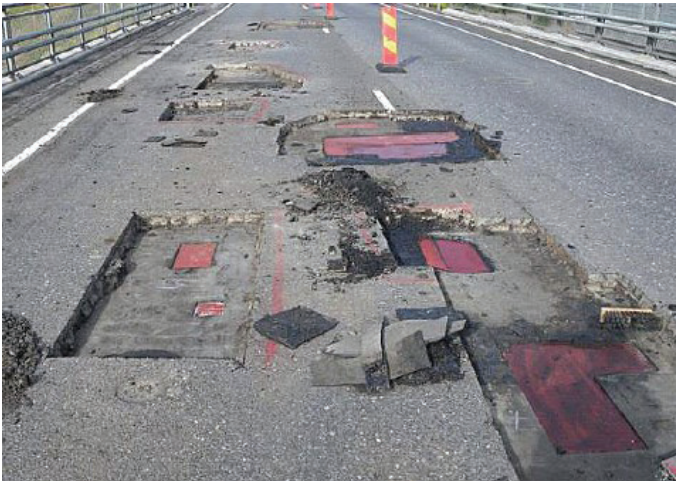
Kuva 1. Kuplimisvauriokohtien avaus uudella sillalla
