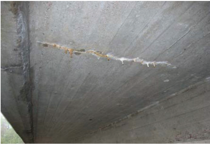
Kuva 2. Vedeneristysten korjaustarve on selvitettävä aina ennen sillan peruskorjausta ja päällystämistä
