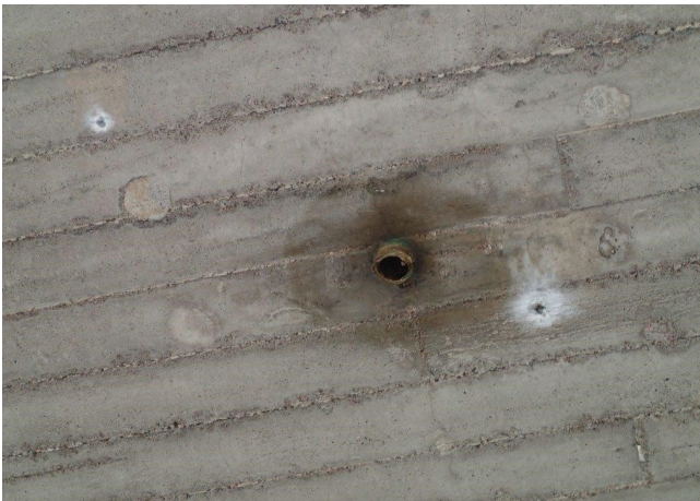
Kuva 1. Jos paineentasausputken ympärillä on kalkkihärmää, mastiksieristys vuotaa
