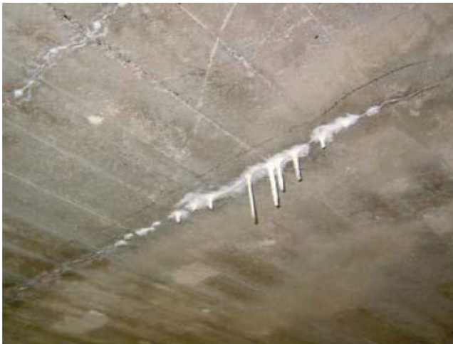
Kuva 2. Vuotavat halkeamat, kalkkipuikot ja kalkkiläiskät ovat merkkejä vedeneristyksen vaurioista
