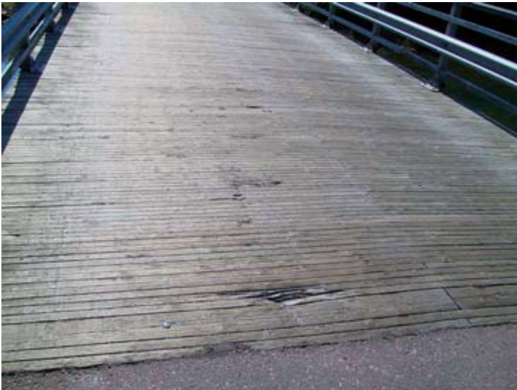
Kuva 2. Päällystyskelpoinen vaurioluokan 2 puukansi
