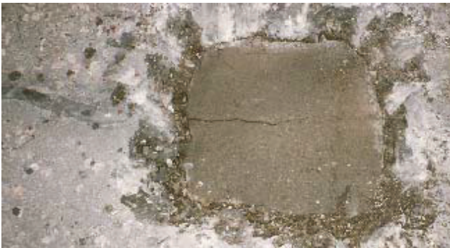
Kuva 3. Asfaltti ja mastiksieristys halki betonikannen halkeaman kohdalla
