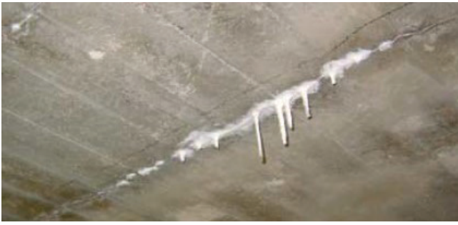
Kuva 2. Kalkkivuotojen jäljet kannen alapinnalla merkkeinä eristysvaurioista
