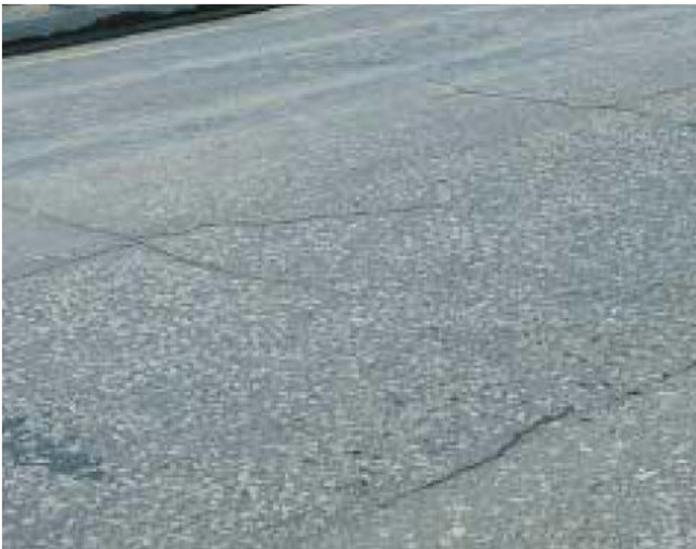
Kuva 1. Avonaiset halkeamat muodostavat vaurioitumisriskin alapuolisille rakenteille
