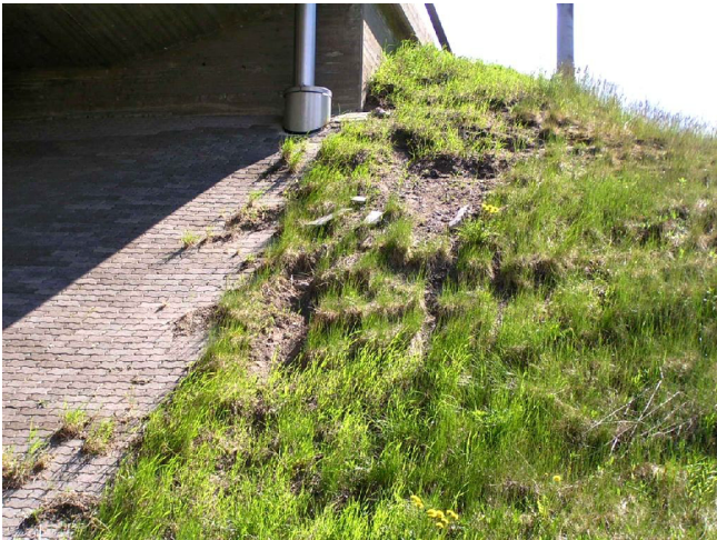
Kuva 2. Liikkuminen luiskassa vaurioittaa nurmiverhousta
