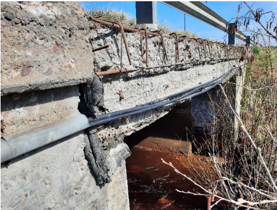
Kuva 1. Klorigirasituksen aiheuttamaa reunapalkin rapautumista (Taitorakennerekisteri)
