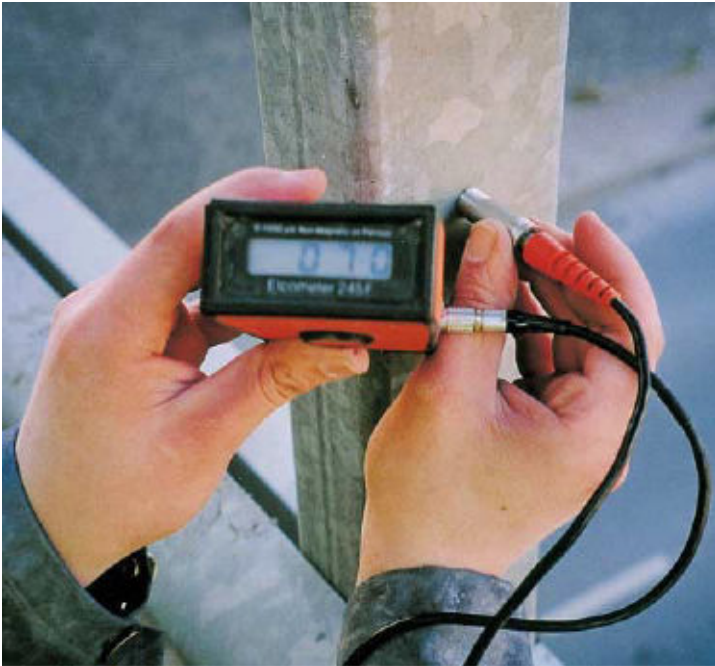
Kuva 2. Sinkkikerroksen ohenemista on seurattava määräajoin tehtävillä mittauksilla
