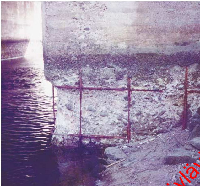
Kuva 1. Laajoja rapautumia on yleensä alusrakenteissa.
