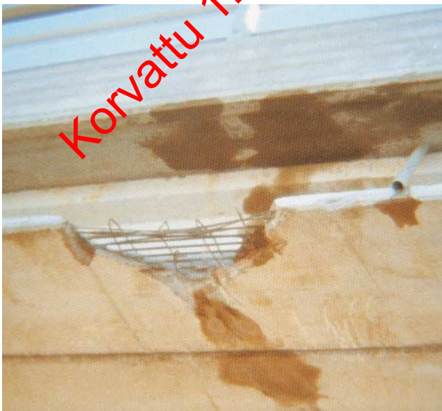
Kuva 2. Törmäysvaurio on korjattava ensi tilassa.
