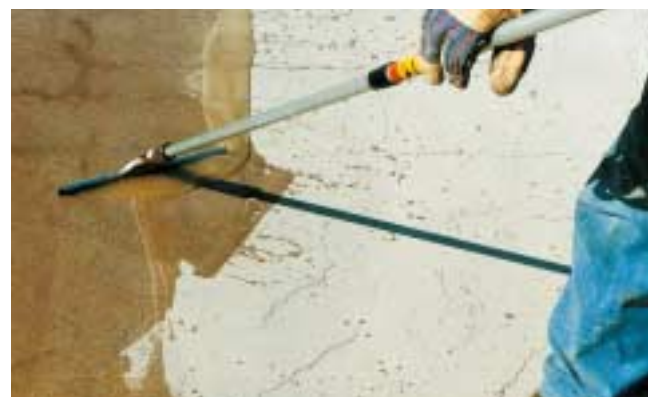
Kuva 13. Halkeilleen pinnan imeytystä ilman halkeamien esikäsitelyä.
