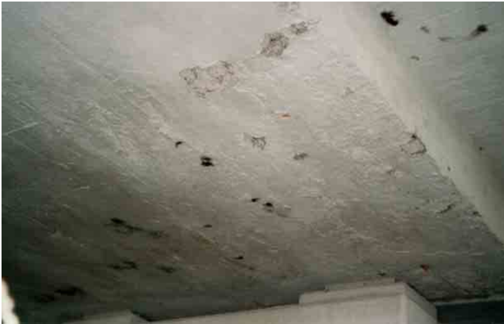
Kuva 6.2 Pinnoitteen irtoamakohtia kannen alapinnassa, Decadex (Teh- taanmäen ylikulku- ja risteyssilta).
