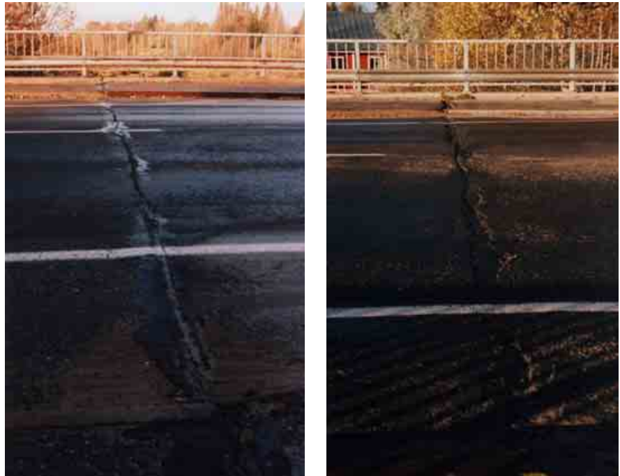
Kuva 3.2 Oulaistenkosken sillan päällysteen saumaukset.
