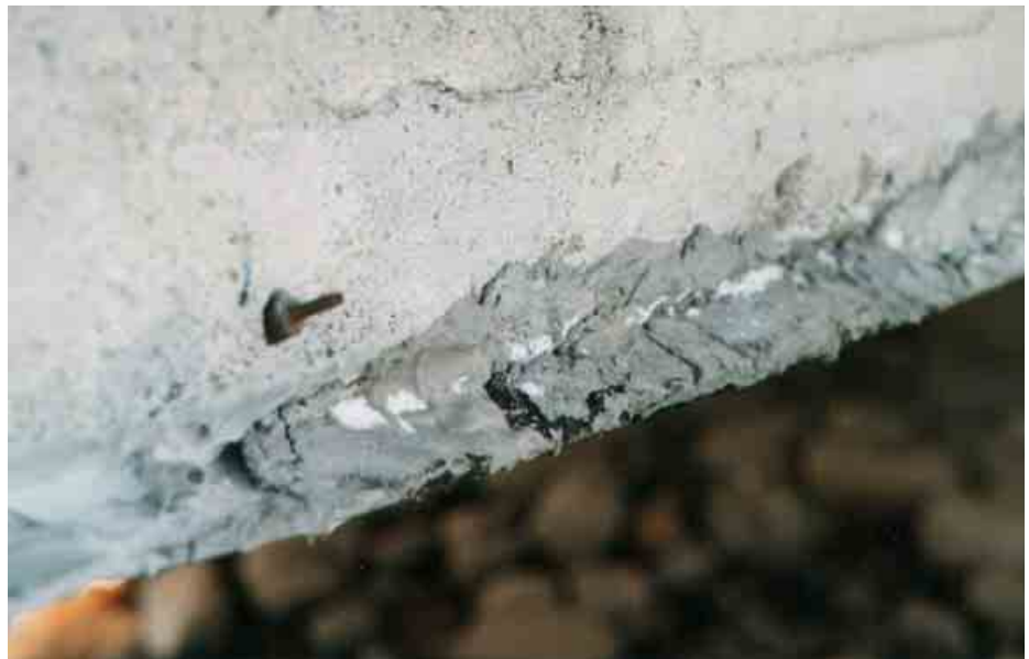
Kuva 5.4b Sulkuainetta levyn ruosteisessa reunassa.
