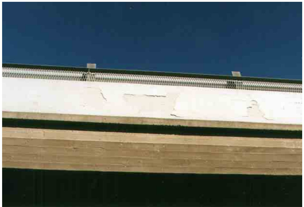
Kuva 6.3 Pinnoitteen irtoamia reunapalkissa, Semppi (Haapalan risteyssilta).
