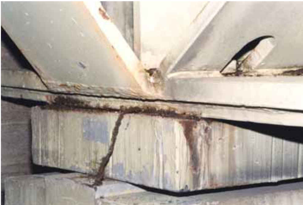
Kuva 6.1 Irronnutta kittiä Haukiperän sillan laakerikiinnityksessä.
