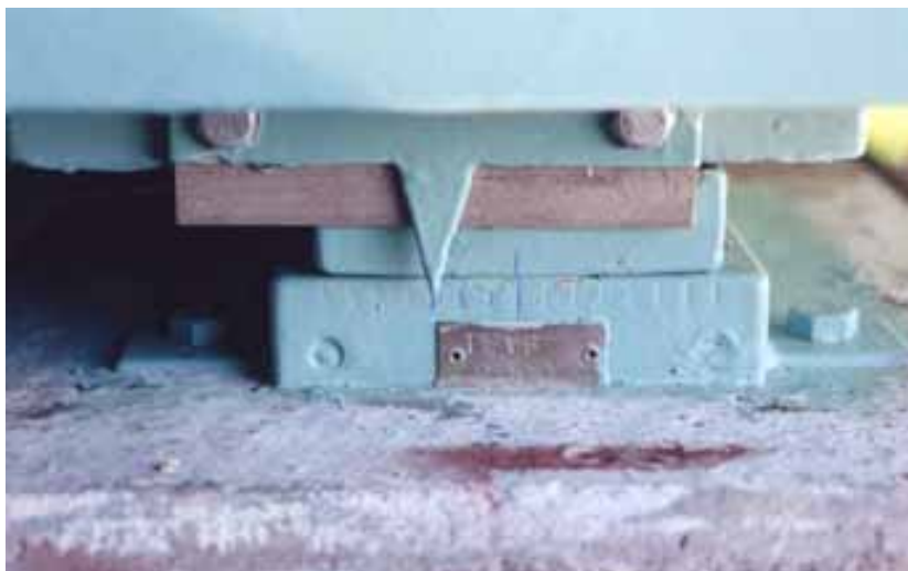
Kuva: Tepaston sillan laakeriennakko. Ilman lämpötila +22 °C.
