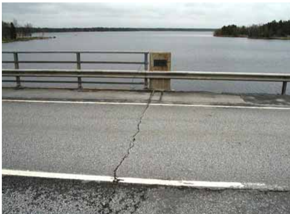
Kuva: Asfaltin halkeama.
