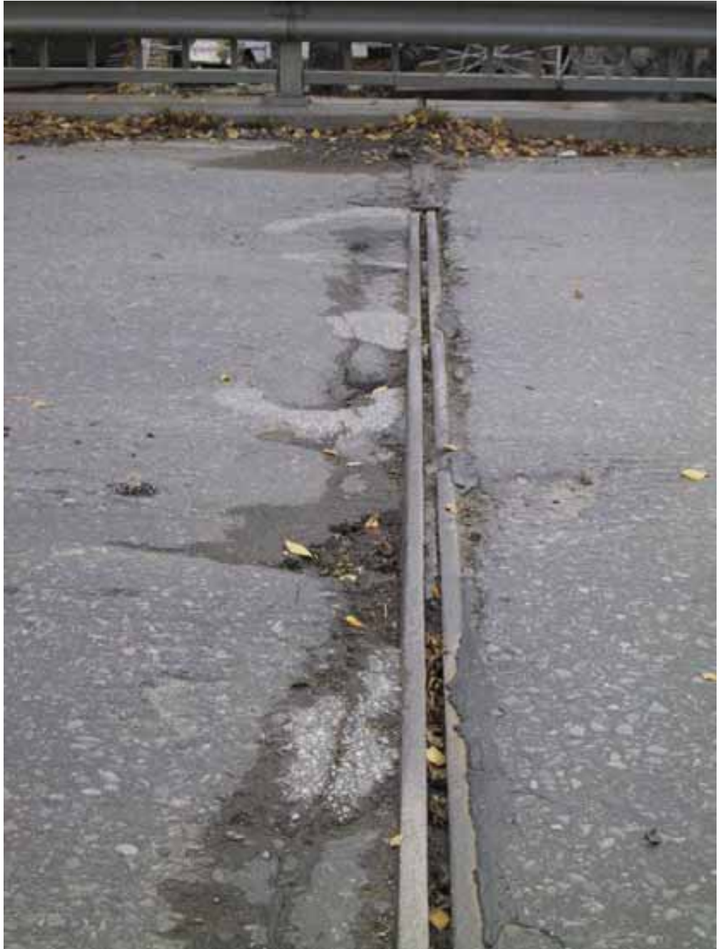
Kuva 3.9 Purkautunut päällyste liikuntasaumalaitteen vieressä.
