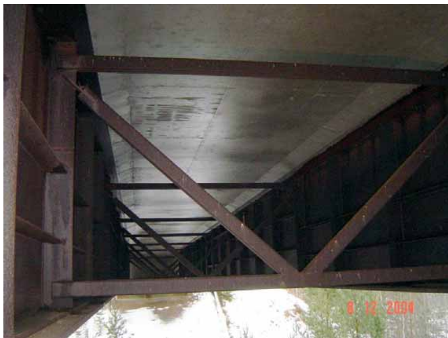
Kuva b) Kannen alapinnan tiivistynyttä kosteutta tarkastuspäivänä.
