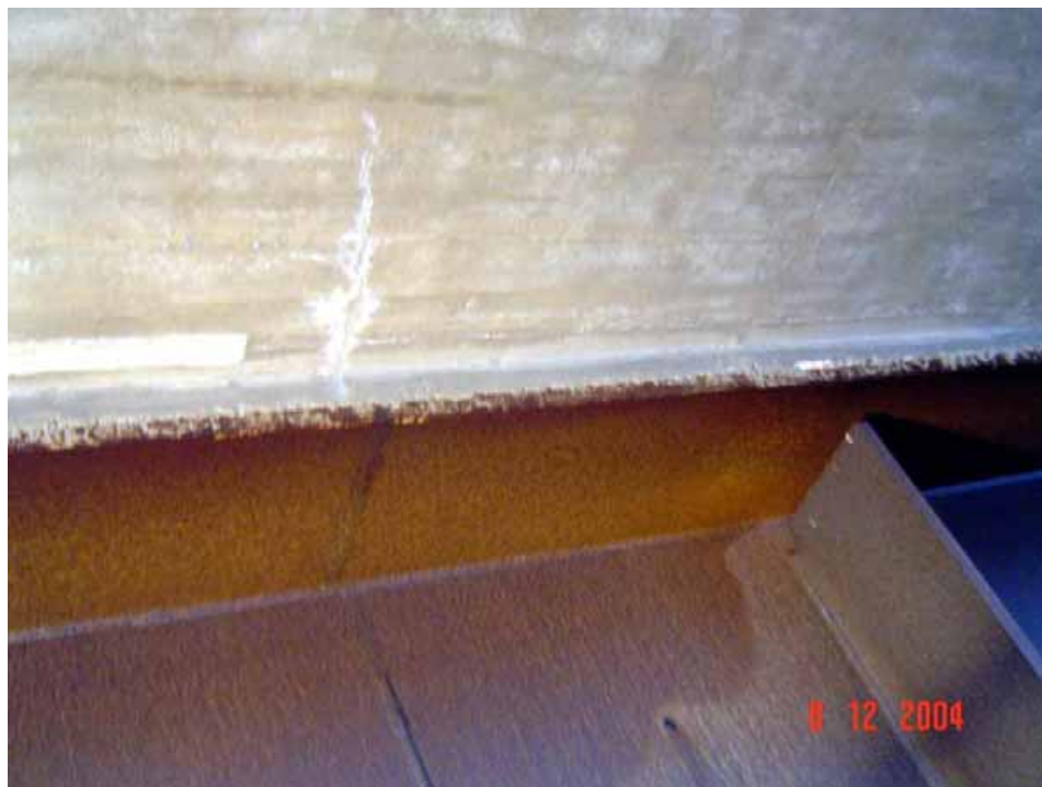
Kuva d) Kalkkihärmettä halkeamassa.
