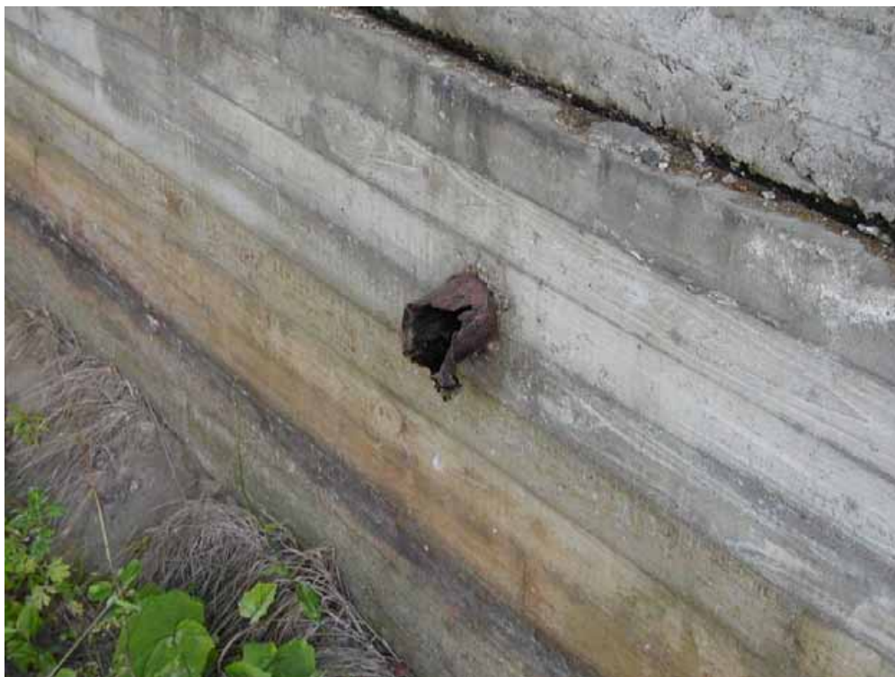
Kuva 3.8 Vedenpoistoputki on ruosteessa.
