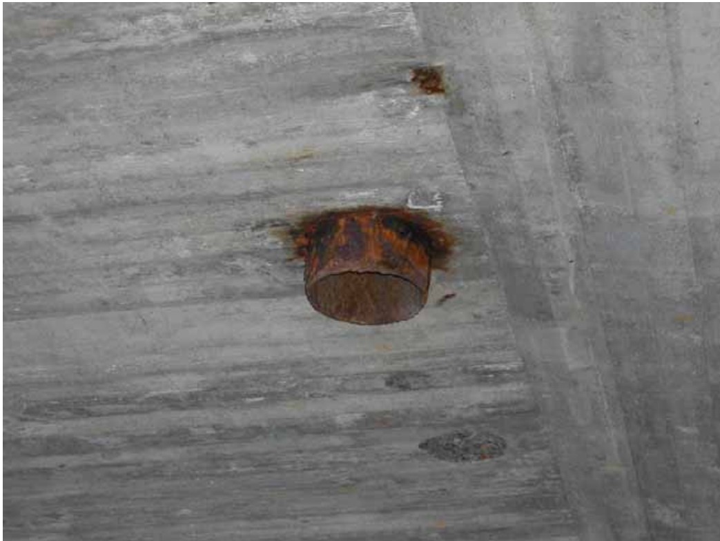
Kuva 3.5 Syöksytorvi on ruosteessa.
