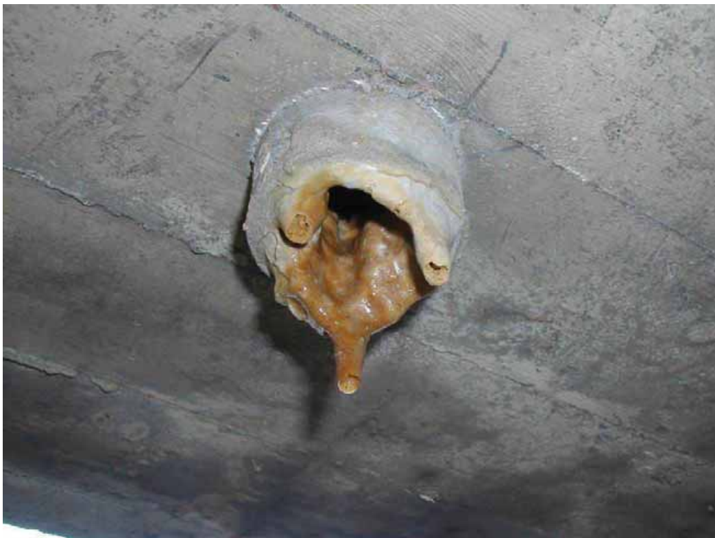
Kuva 3.6 Tippuputki on tukossa.
