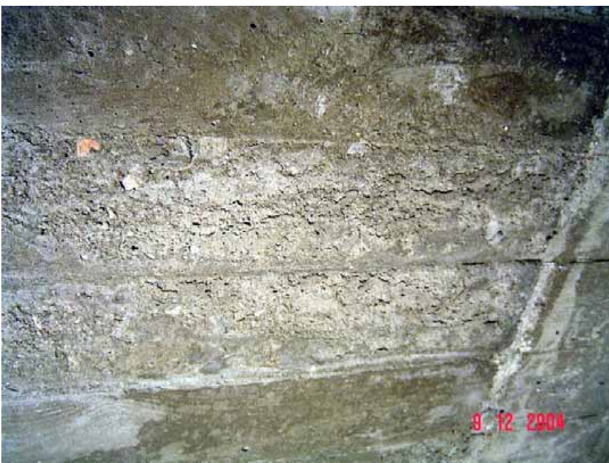
Kuva b) Rapautunutta betonipintaa kannen ulokkeella.
