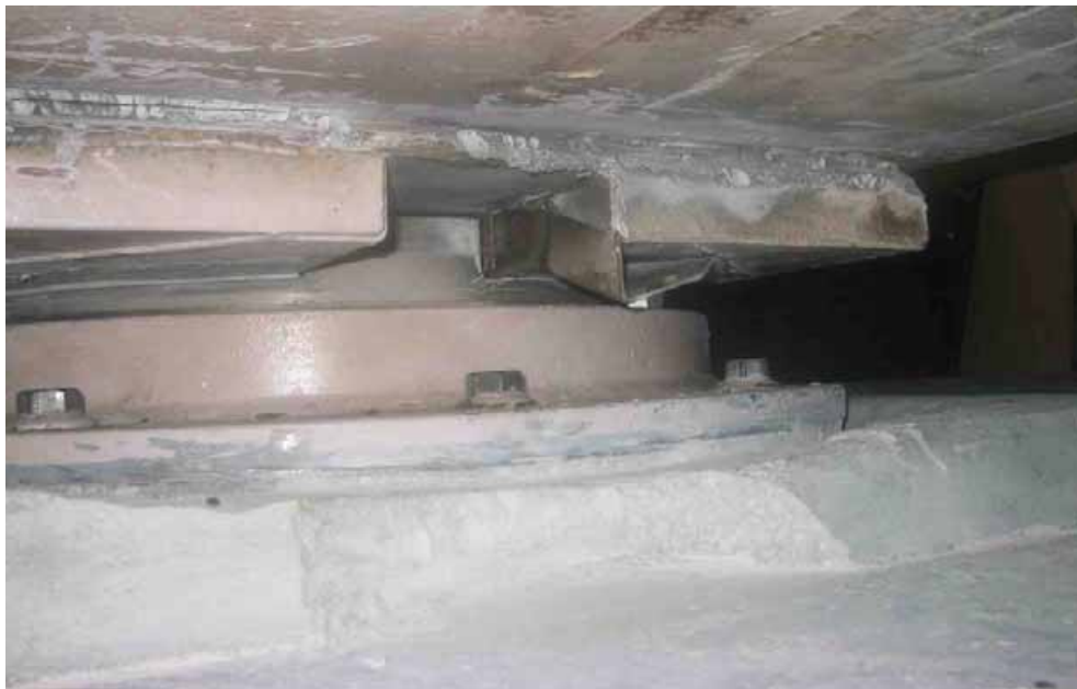
Kuva 4.2 Liukulevyn rikkoontuminen Raippaluodon sillan laakerissa.
