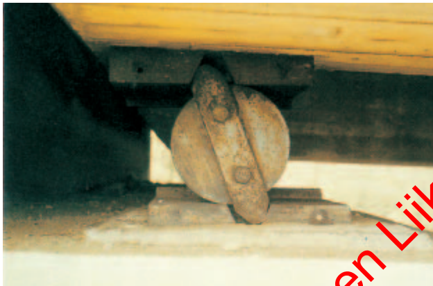
Kuva 134. Ruostunut ja liikaa kallistunut laakeri.
