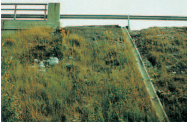
Kuva 145. Eroosiovaurio pintavesikourun vieressä.
