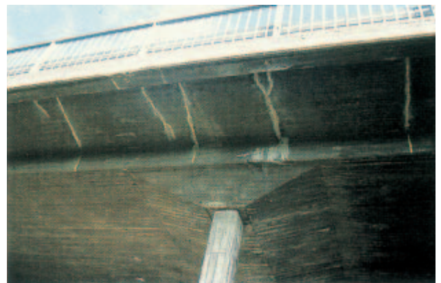
Kuva 115. Ohuissa ulokkeissa on usein eri syistä johtuvia halkeamia.
