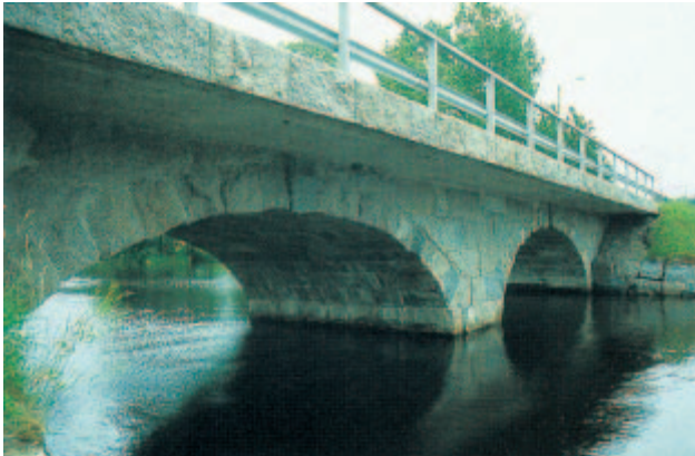
Kuva 78. Kalliolle perustetuissa kivisilloissa on harvoin vaurioita.
