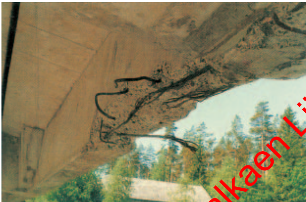
Kuva 116. Törmäysvaurio elementtipalkin alareunassa.
