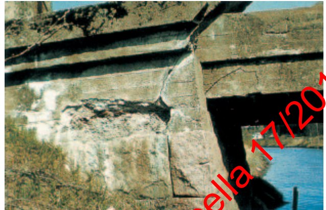
Kuva 104. Halkeamasta on aiheutunut rapautumisvaurio.
