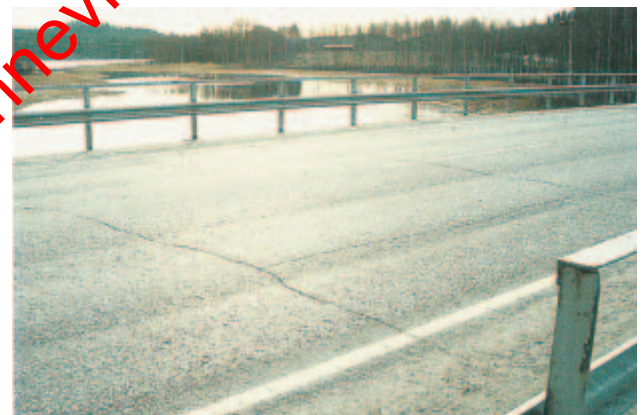
Kuva 125. Pahat kulumisurat sillan päällysteessä.
