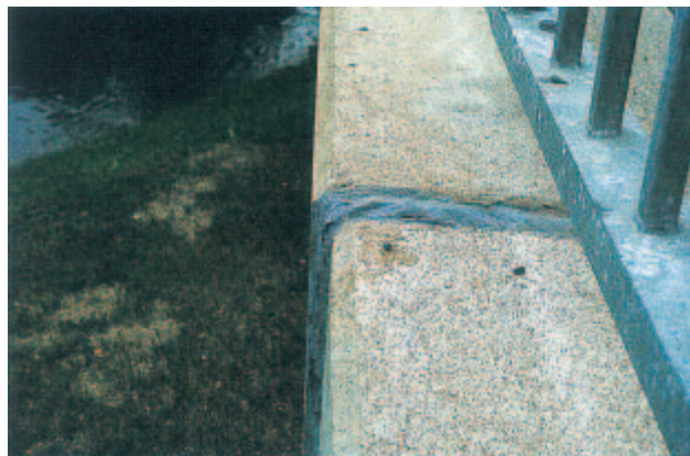
Kuva 98. Alusrakenteen liikkuminen näkyy hammastuksena alus- ja päällysrakenteen saumassa.
