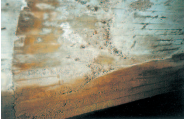
Kuva 83. Huonosti tiivistettyjä kohtia betonipinnassa.
