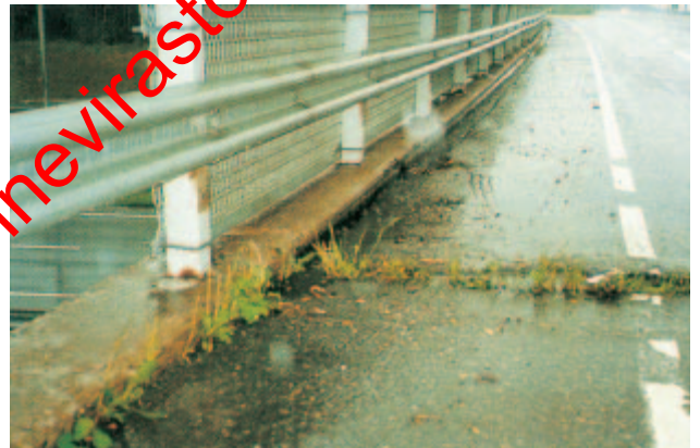
Kuva 129. Huonosti hoidettuja päällysteen saumauksia.
