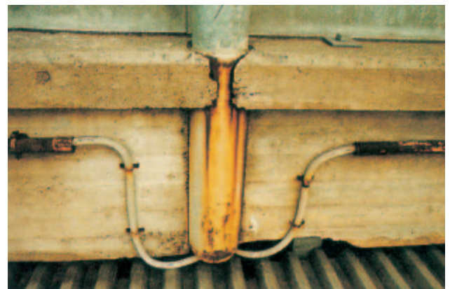
Kuva 138. Siltaan kiinnitetyt putket ja kiinnikkeet ovat usein ruosteessa.
