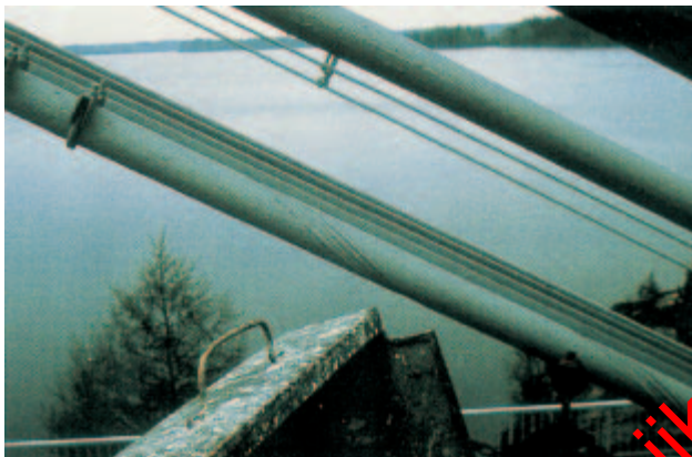
Kuva 118. Riippuköyden katkenneita säikeitä.
