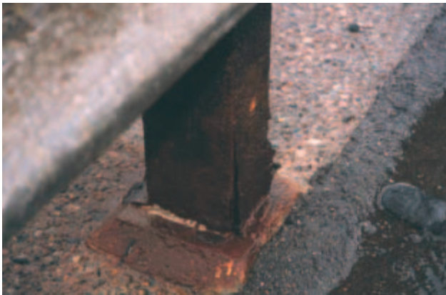
Kuva 136. Vesi on jäänyt kaidepylvään sisään ja halkaissut pylvään. Lisäksi pylväs on ruostunut pahoin.
