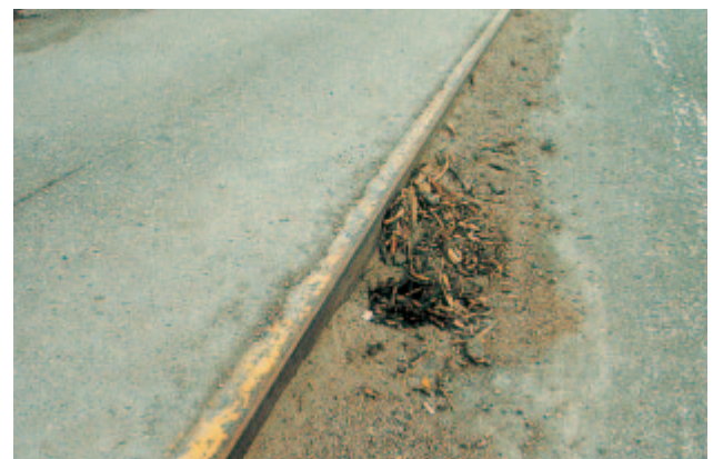
Kuva 141. Hoidon laiminlyönnin seurauksena tukkeutunut syöksytorvi.
