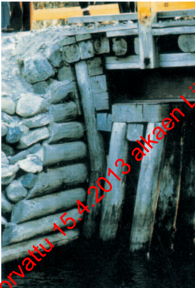
Kuva 108. Liian korkea puurakenteinen maatuki.
