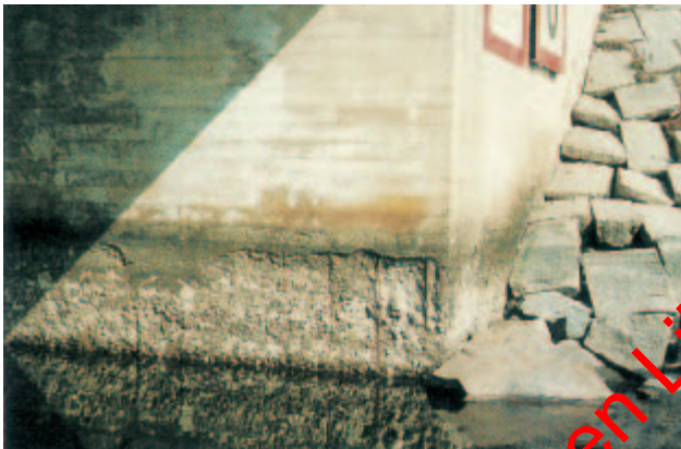
Kuva 103. Betonirakenteen pintavaurio vedenpinnan vaikutusalueella.
