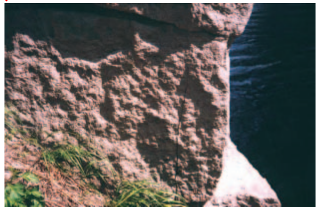
Kuva 107. Holvin muodonmuutoksesta aiheutunut halkeama kannan kivessä.
