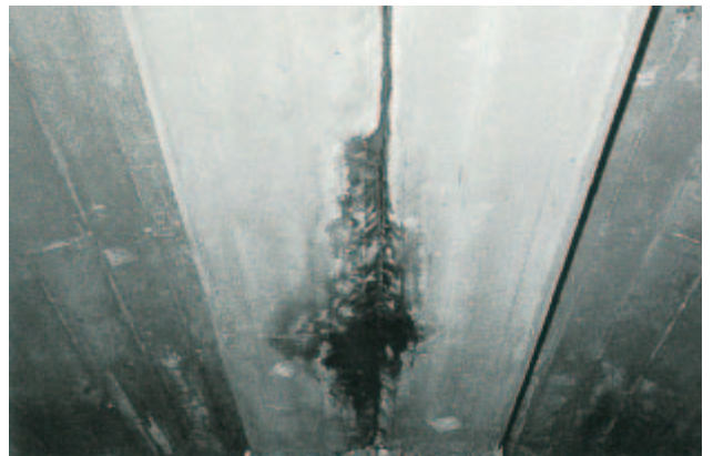
Kuva 130. Vesivuoto halkaistun sillan keskisaumasta.
