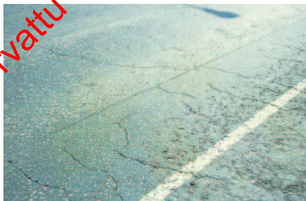
Kuva 124. Valuasfaltti halkeilee, jos suhteitus on virheellinen.
