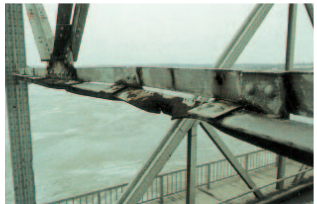
Kuva 120. Törmäyksessä vaurioitunut poikkiside.
