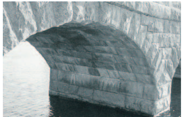
Kuva 111. Kokoonpuristuvien maakerrosten vuoksi kallistunut välituki.
