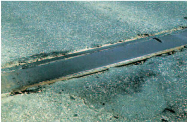
Kuva 131. Irtonnut liikuntasaumalaite vaarantaa liikenneturvallisuutta ja aiheuttaa melua.
