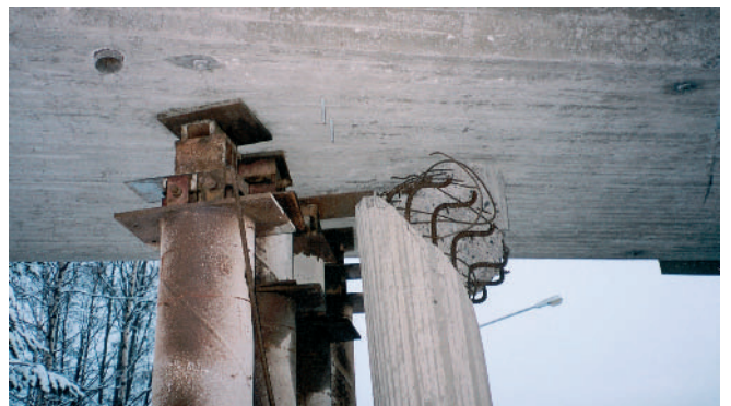
Kuva 10. Sillan välituen pilarin törmäysvaurio ja väliaikainen tuenta.
