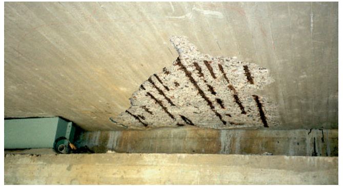
Kuva 7. Teräskorrosio on irrottanut betonipeitteen.
