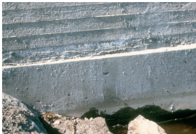
Kuva 42. Veden pinnan vaikutusalueen rapautu-misvaurio on korjattu huuhtoutumattomalla beto-nilla.
