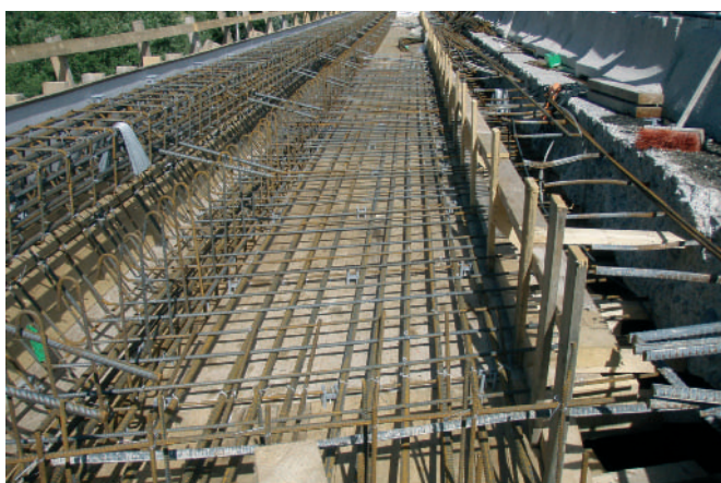
Kuva 3. Raudoitusta joudutaan usein uusimaan sillankorjauksissa
