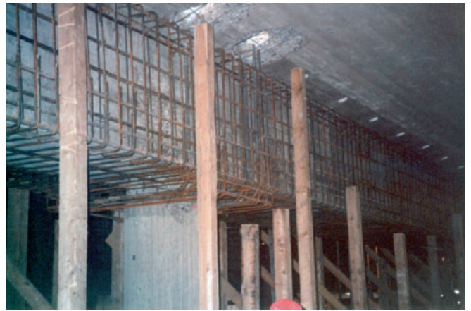
Kuva 51. Teräsbetonipalkki on vahvennettu lisä-raudoitteella.
