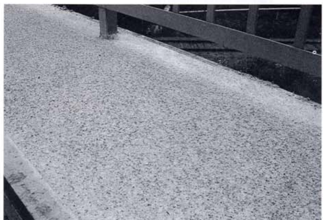
Kuva 13. Ohuiden muotoiluvalujen halkeilu voidaan estää kuiduilla.
