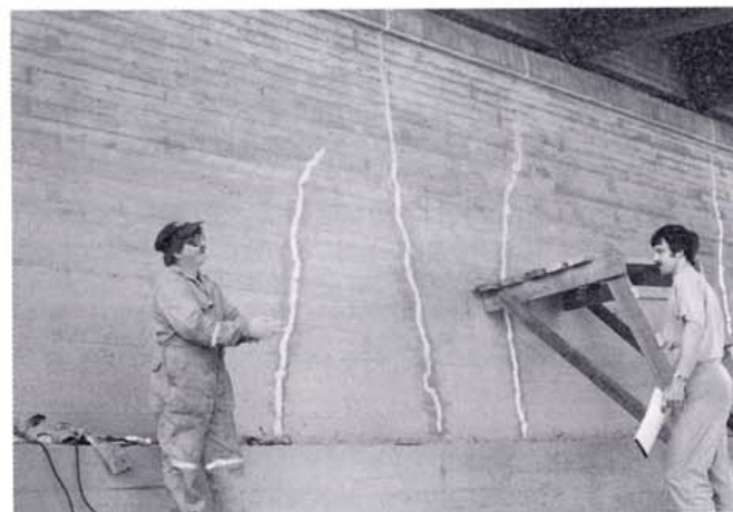
Kuva 15. Injektoituja maatuen kutistumishalkeamia.
