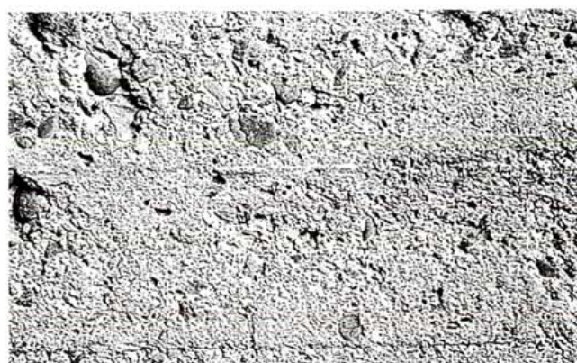
Kuva 46. Voimakkaasti suihkupuhdistettu betonipinta.
