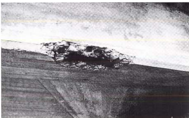
Kuva 4. Raudoitustangon betonipeitteen lohkeama.
