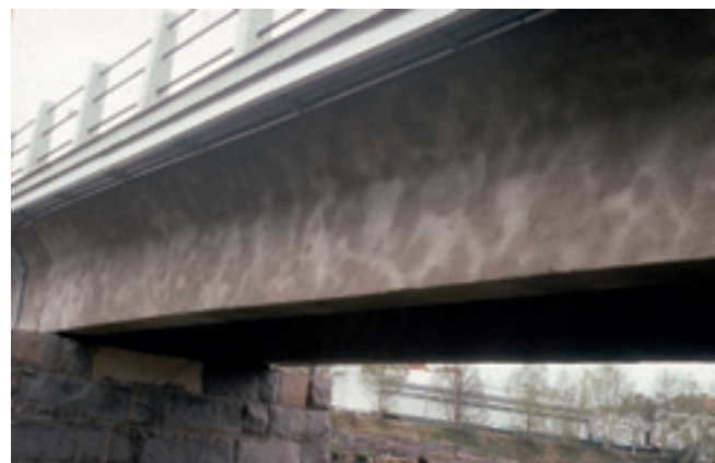
Kuva 18. Värisävyltään häiritsevästi vaihteleva ruiskubetonin pinta.
