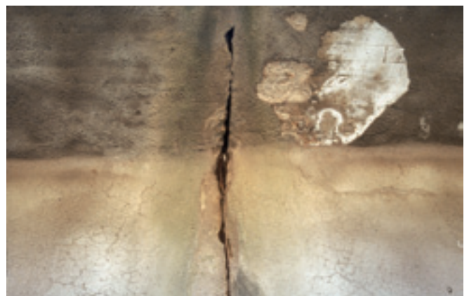
Kuva 11. Ohut ruiskubetonikerros lohkeaa pois.
