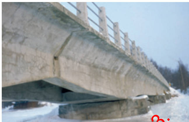
Kuva 5. Savisillan 1930-luvulla tehty ruiskubetonia ennen vuonna 1986 tehtyä korjausta.
