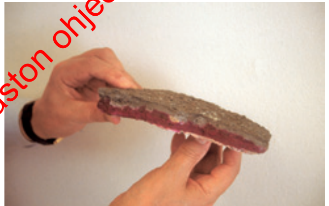
Kuva 10. Ruiskubetoni on karbonatisoitunut 10 vuodessa lähes kokonaan.
