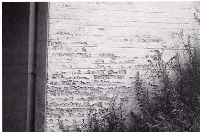
Kuva 7. Liian tiiviin pinnoitteen aiheuttama pakkasvaurio.
