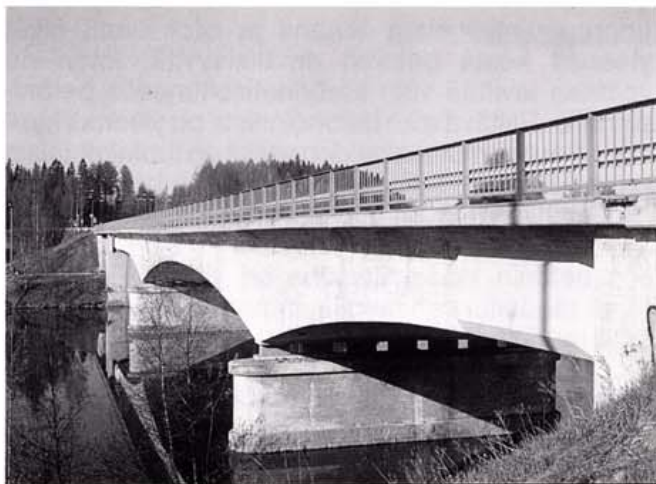
Kuva 4. Slammattuja betonipintoja (Nokianvirran silta, Nokia).
