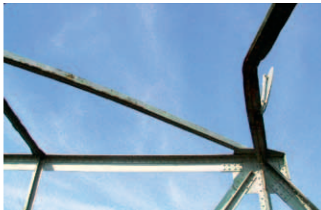
Kuva 13. Törmäysvaurio portaalin poikkisiteessä.
