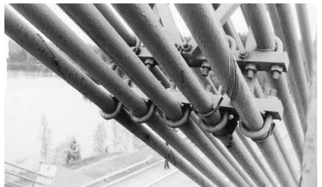
Kuva 11. Riippuköyden säikeitä on katkennut.
